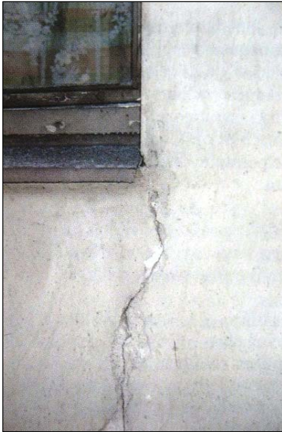
Kuva 8. Vesi- ja suojapeltien virheellinen kiinnitys ja kaltevuus sekä ulosveto rakenteesta aiheuttavat veden kulkeutumisen rakenteeseen ja siten sekä alustan että maalipinnan paikallisen vaurioitumisen. [24, s. 27.]
