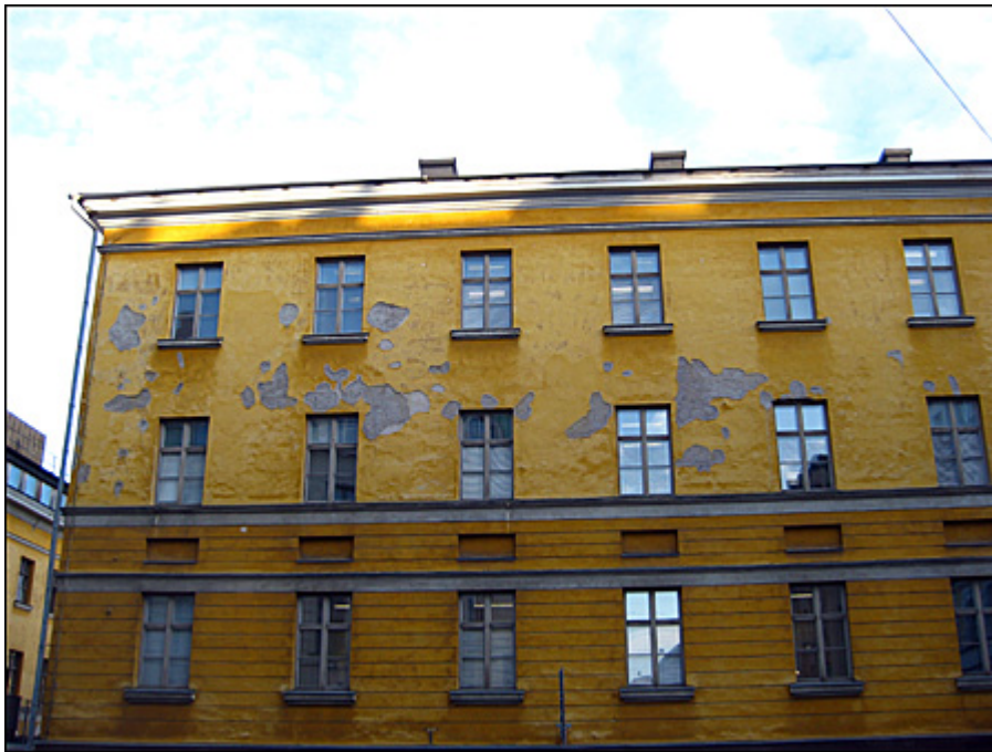
Kuva 1. Kyseinen pääkaupunkiseudulla sijaitseva kohde kaipaa julkisivuremonttia. [27]
