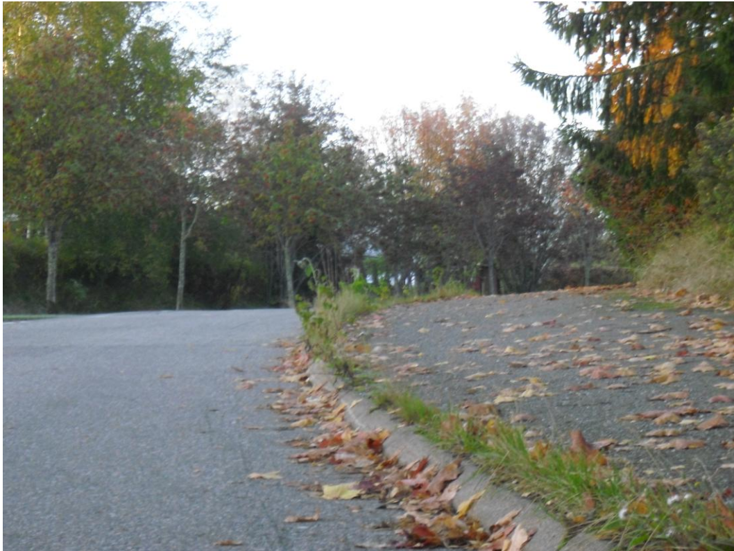
Kuva 20. Jalkakäytävän ja reunakiven välistä kasvava rikkaruoho on päässyt jo pahaksi.
