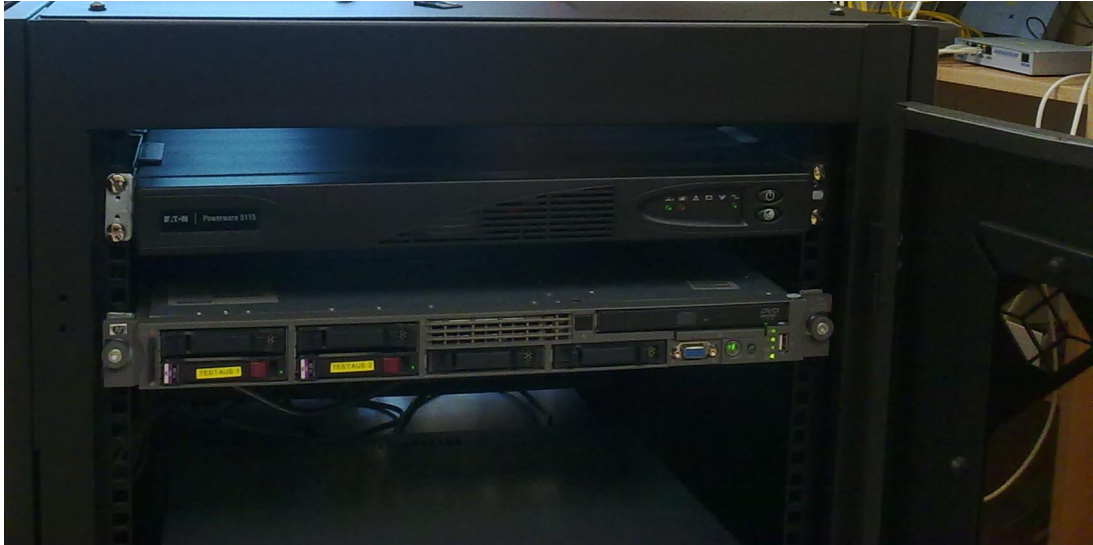
Kuva 5.2 Kuvassa ylempänä UPS ja palvelin alempana
