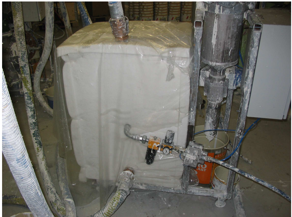
Kuva 15. Pumppu koteloituna akustiikkalevyillä
