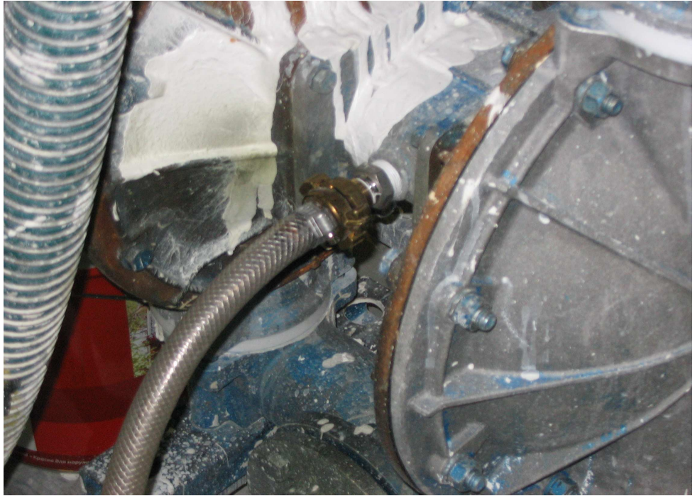
Kuva 11. Letku kiinni kynsiliittimillä pumpussa
