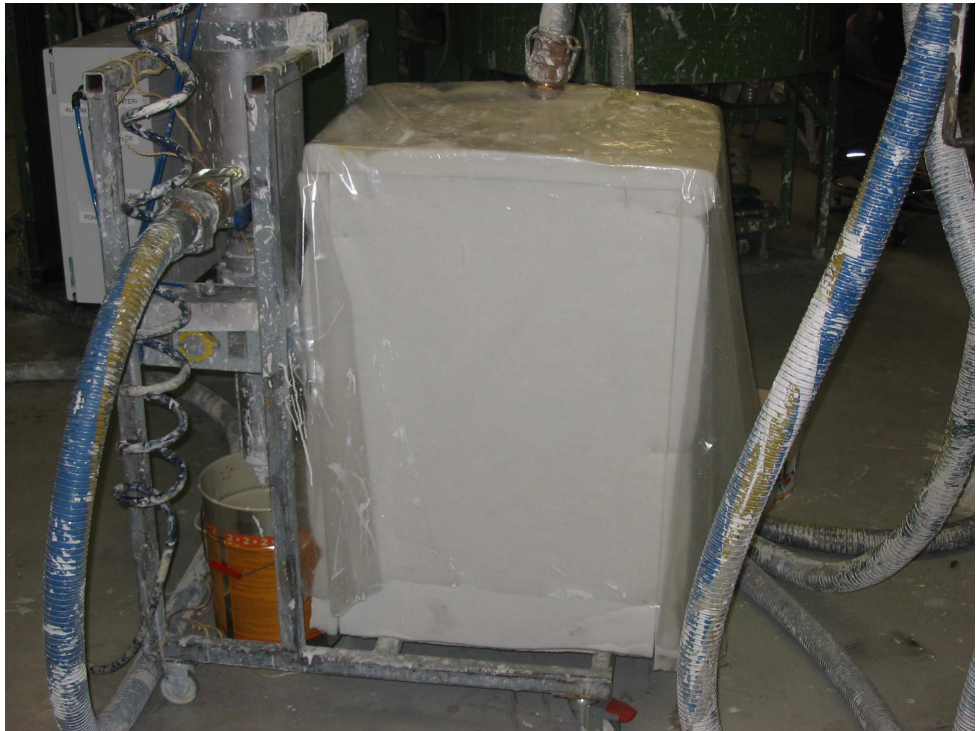
Kuva 16. Pumppu koteloituna akustiikkalevyillä
