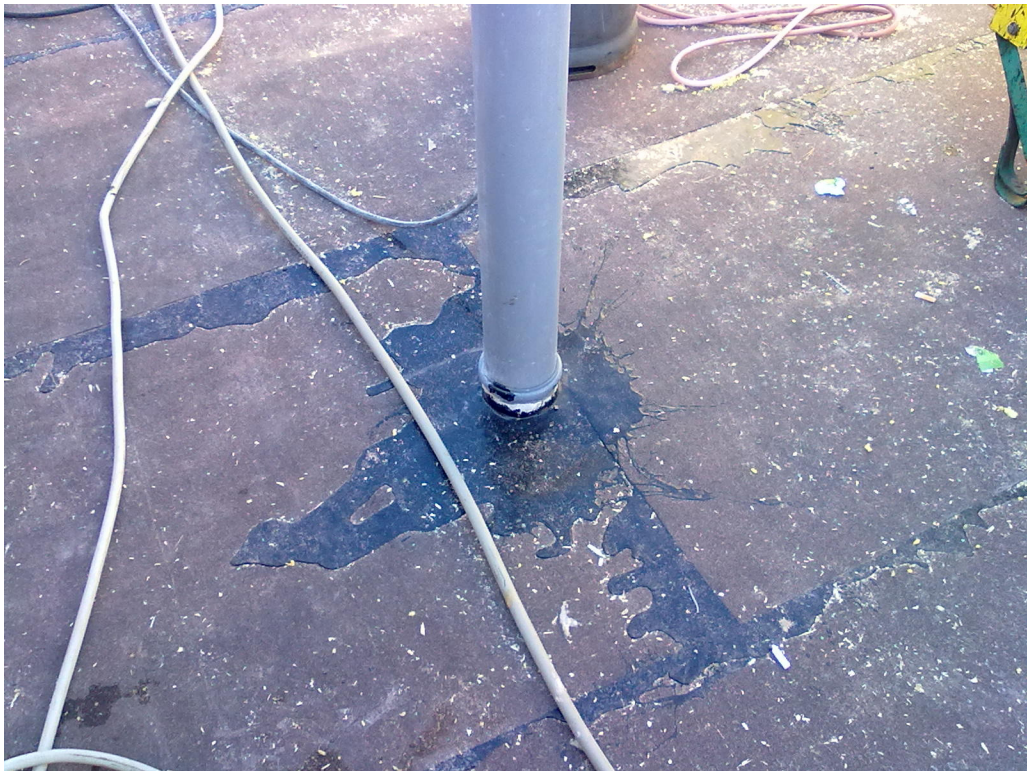
Kuva 6. Höyrinsulku sekä oikeaoppinen läpivienti höyrinsulkulaipalla asennettuna.
