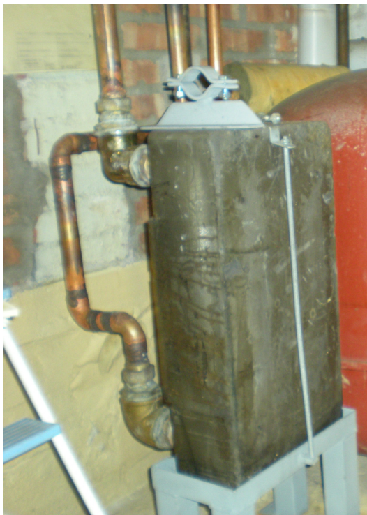
Kuva 7: Lämpimän käyttövesipiirin lämmönvaihdin.
