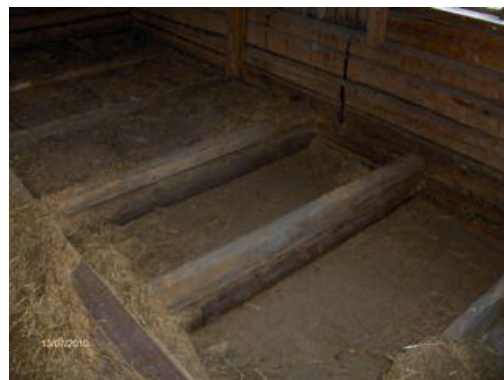
Kuva 4: Eristeet on poistettu, naulauspuut, kannakehirret ja alapuolen kattopaneeli nähtävillä (Kuva: Jari Ihainen)
