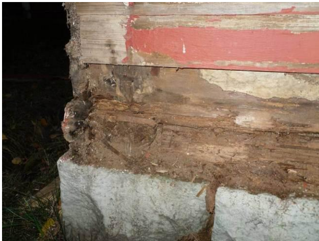
Kuva 14. Keittiönpäädyn nurkka oli pahasti lahonnut.
