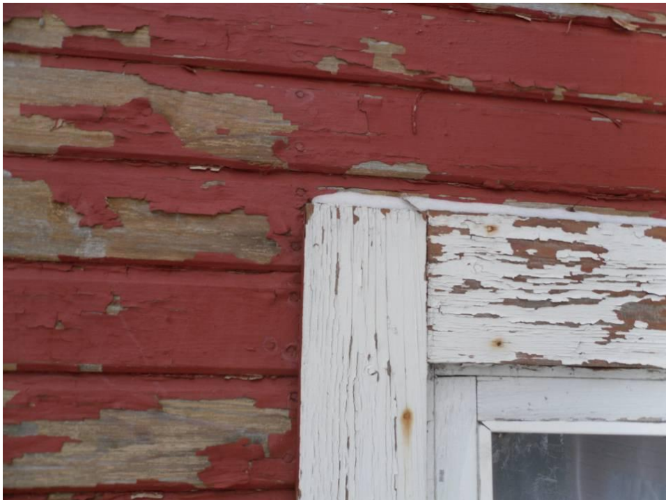
Kuva 5. Ulkovuorauksessa näkyvät vanhat pintakerrostumat. Seinämaalina on käytetty keltaista, ikkunan vuorilaudat ovat olleet ruskeat ja itse karmit valkoiset.
