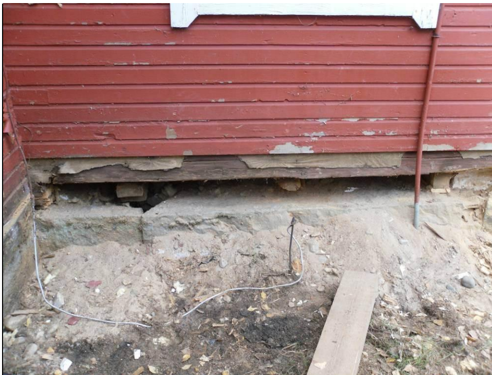
Kuva 16. Keittiönpäädyistä poistettiin lähes läpi asti lahonnut alin hirsi.
