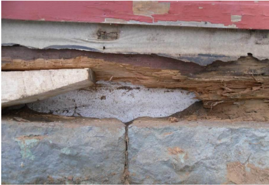
Kuva 11. Keittiön kellaria kiertävä styroksilevytys paljastui, kun alimman hirsikeran lahovaurioita poistettiin.
