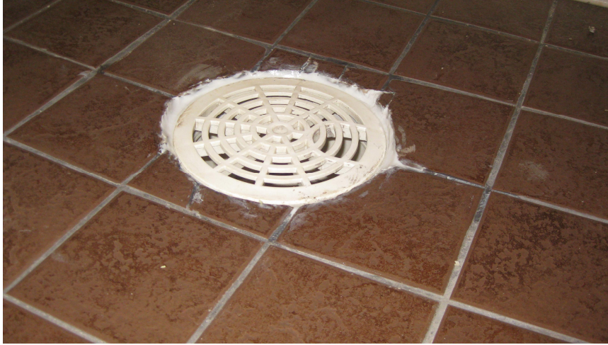
Lattiakaivo laatoitusta matalammalla. Korokerengas puuttuu. Asunto 6.
