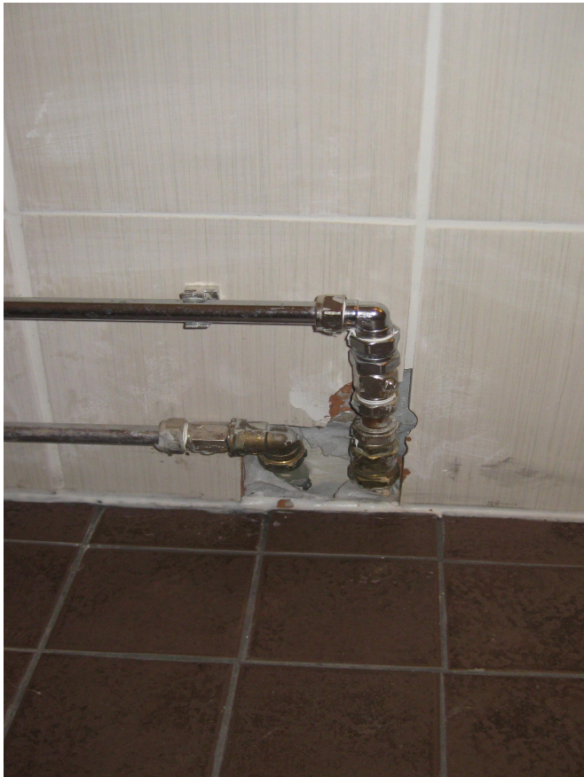
Puutteellinen läpiviennin tiivistys. Asunto 6.
