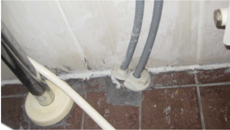
Puutteellinen läpiviennin tiivistys. Asunto 6.
