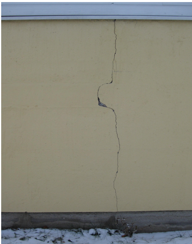
Halkeama julkisivussa ja sokkelissa.
