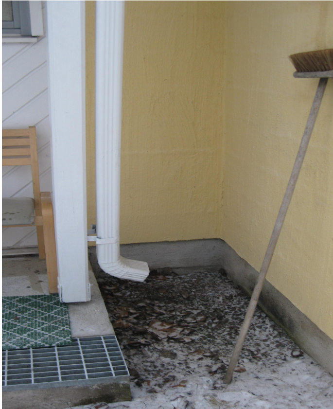
Sadevedet lätäköityvät rakennuksen vierustalle.
