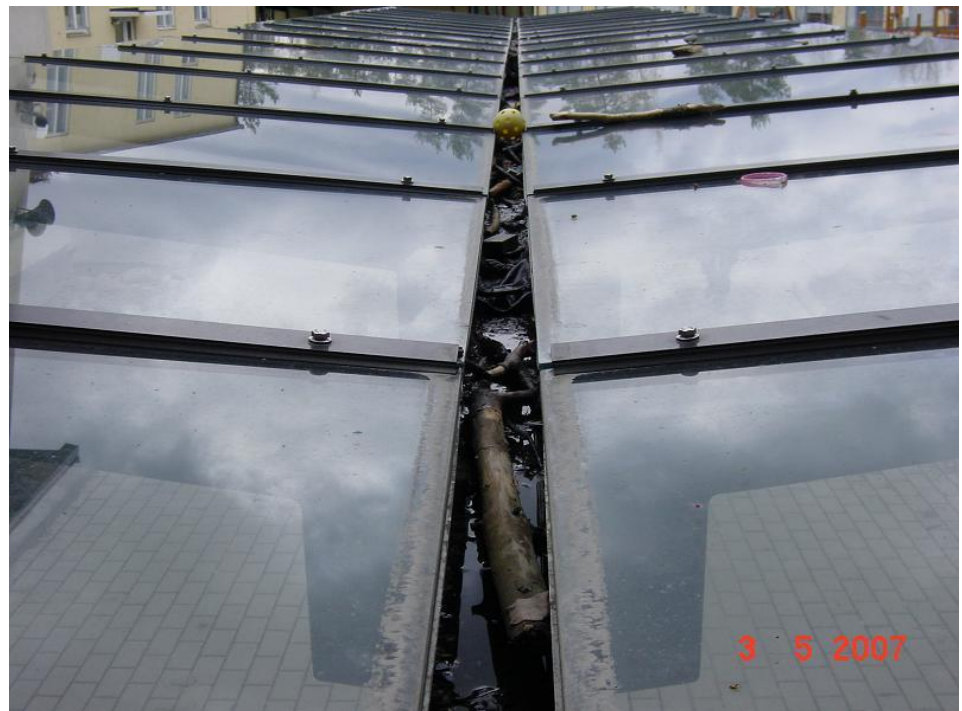
Kuva 12 Vesikaton kourujen puhdistus on laiminlyöty.
