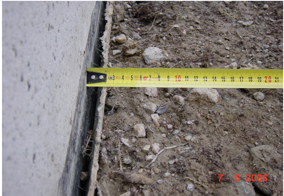
Kuva 6 Sokkelin bitumikermin huonosti kiinnitetty reuna.
