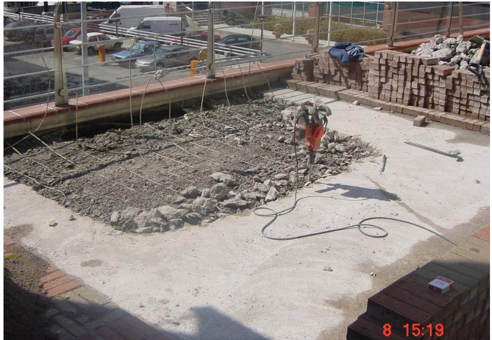
Kuva 15 Käännetynkaton vesieristyksen korjaus vaatii pintarakenteiden purkua.
