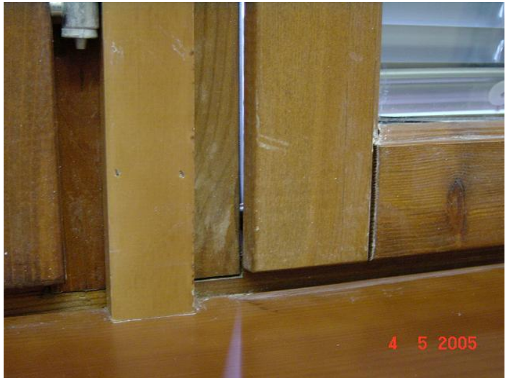
Kuva 11 Ikkunanpuitteen ja karmin väliin on jäänyt muutaman millin rako. Ikkunan puite on liian pieni karmiin. Ikkuna on kuitenkin asennettu viasta huolimatta. Kuvassa ikkuna on kiinni, vaikka näyttää, että se on raollaan. /12./
