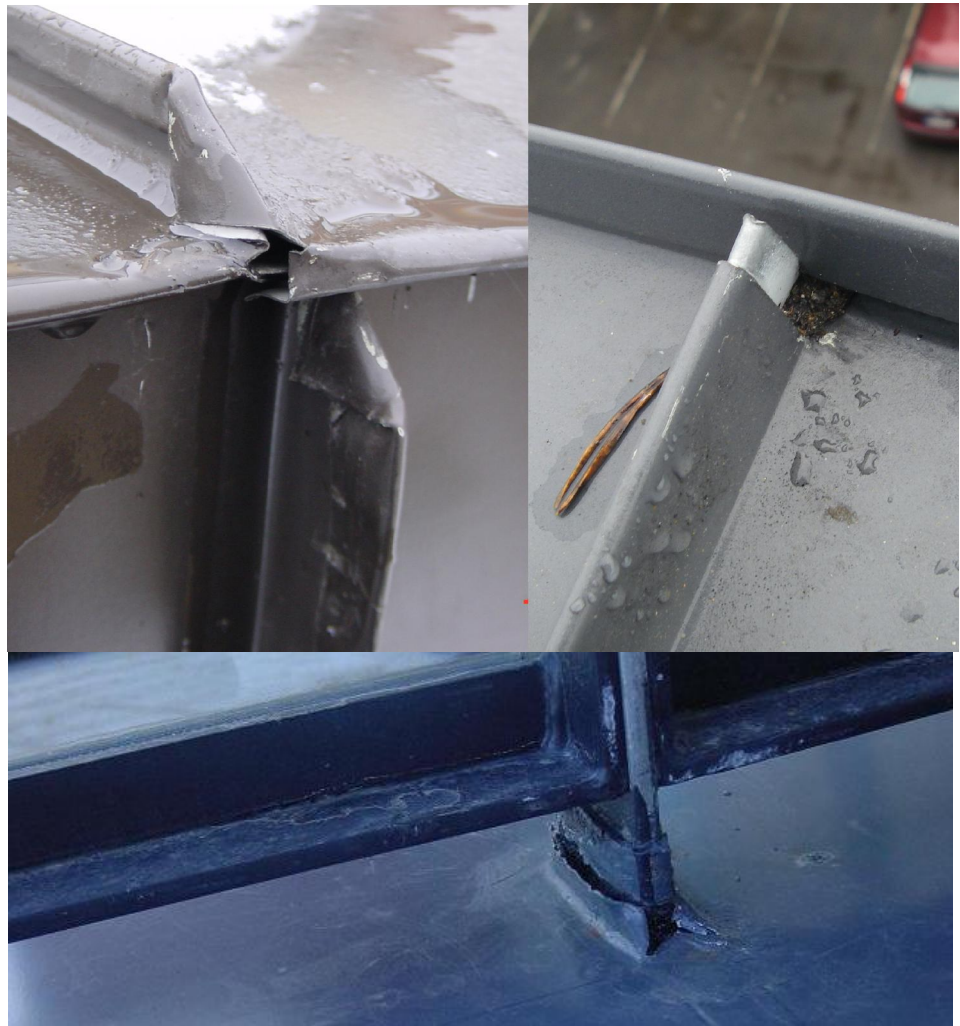
Kuva 14 Laadunvarmistuksessa helposti havaittavia peltikaton työvirheitä /12/.
