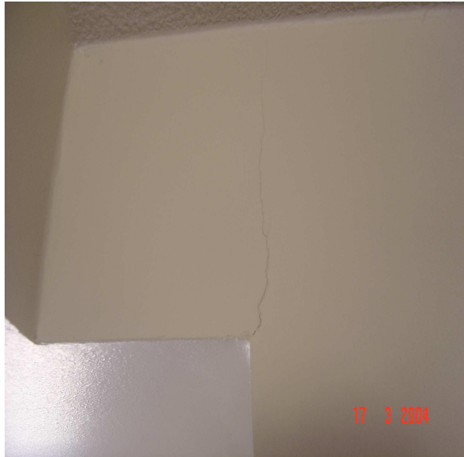
Kuva 7 Kipsilevyn ja betoniseinän rajapinnan halkeama /8/.
