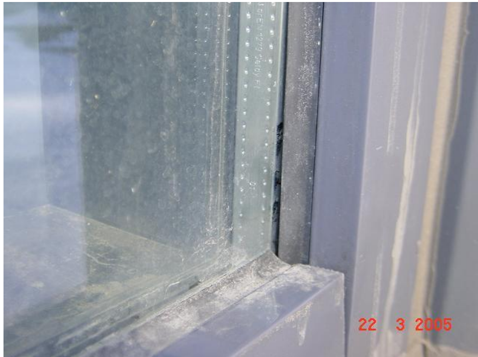
Kuva 19 Teräs-lasi -julkisivun huono tiivistys
