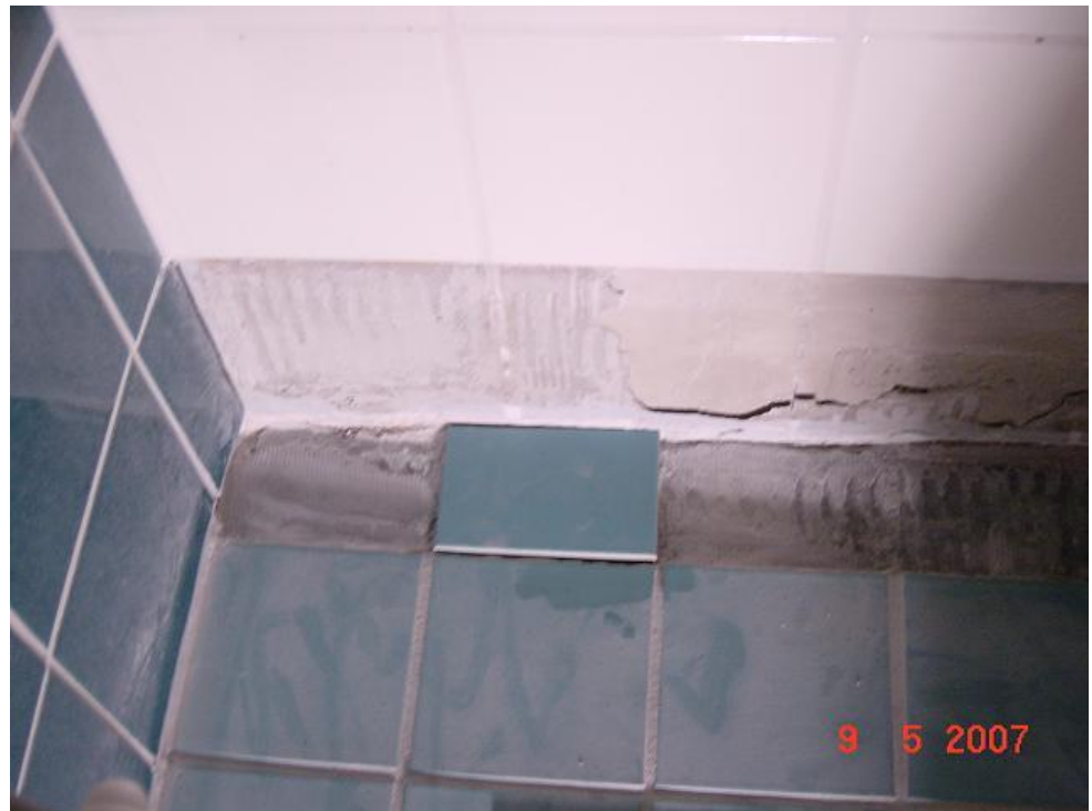
Kuva 2 Betonilaatan käyristymisen ja virumisen aiheuttama laattojen irtoaminen lattian reunoilta.
