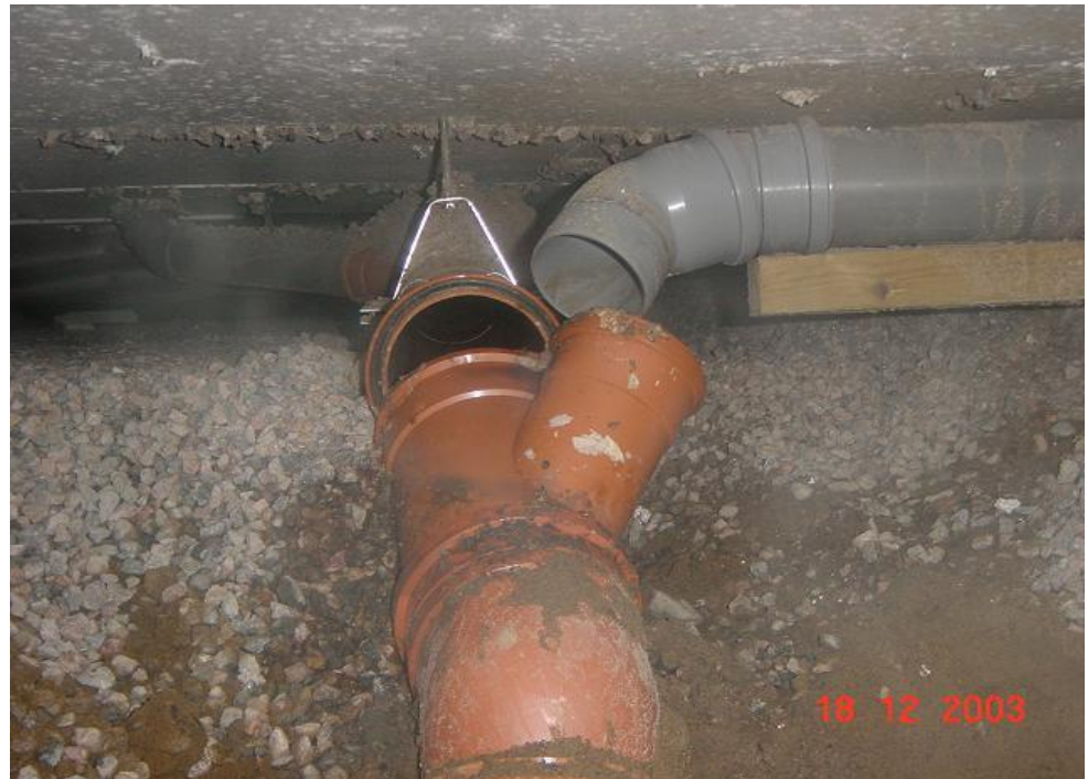
Kuva 4 Maan painumisen aiheuttama viemäririkko.
