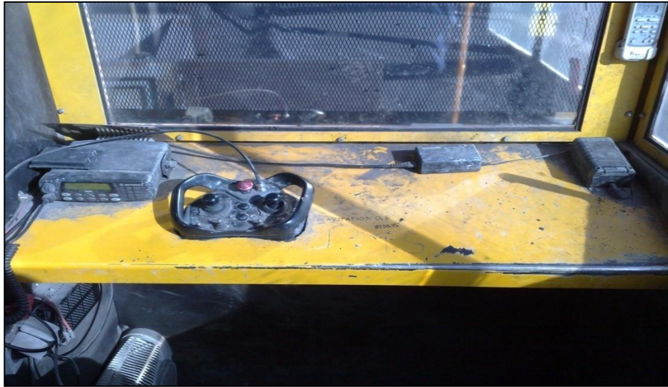
Kuva 9. Kuonauskoneen vanha ohjausjärjestelmä
