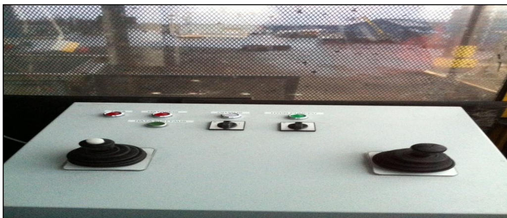
Kuva 23. Uusi ohjauspulpetti asennettuna
