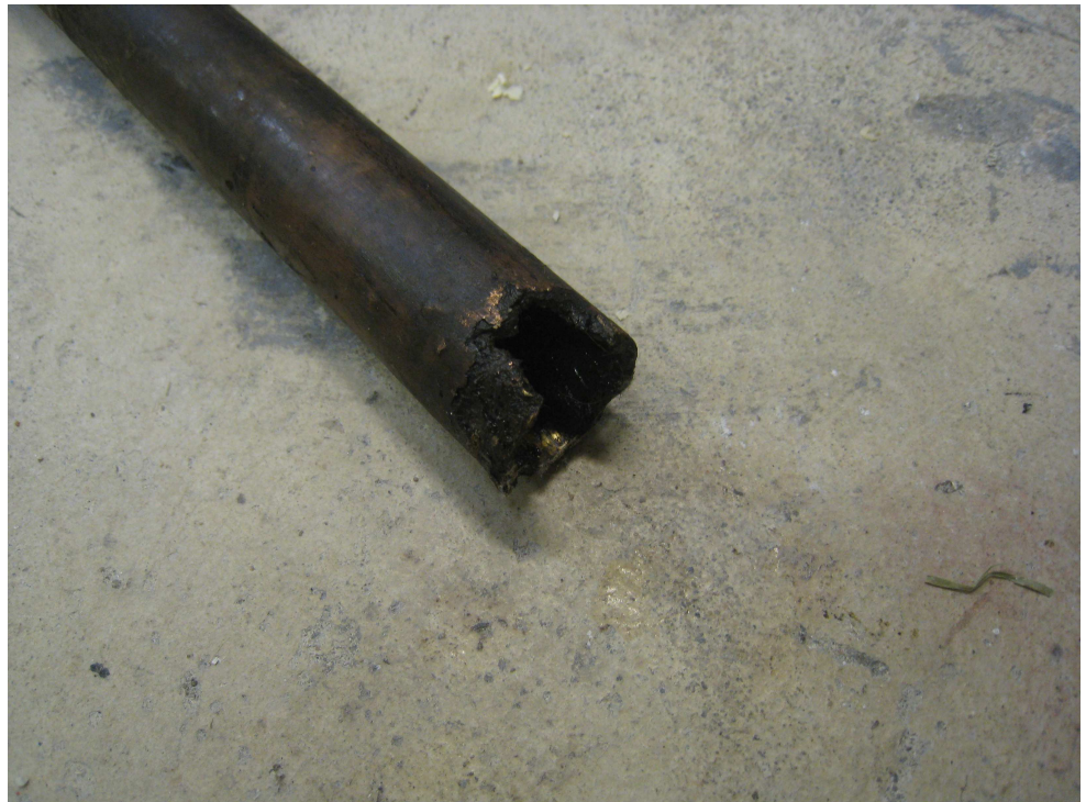
Kuva 4: Vannasputken peräpäähän murtumavaurio
