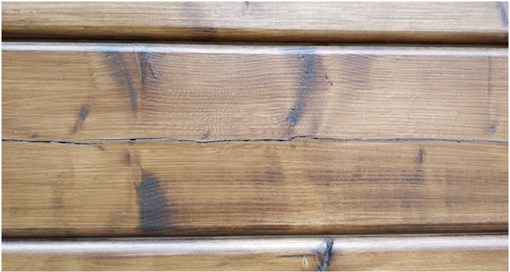
Kuva 119. Länsiseinän suurimpia halkeiluja (Hyvärilä 2018)
