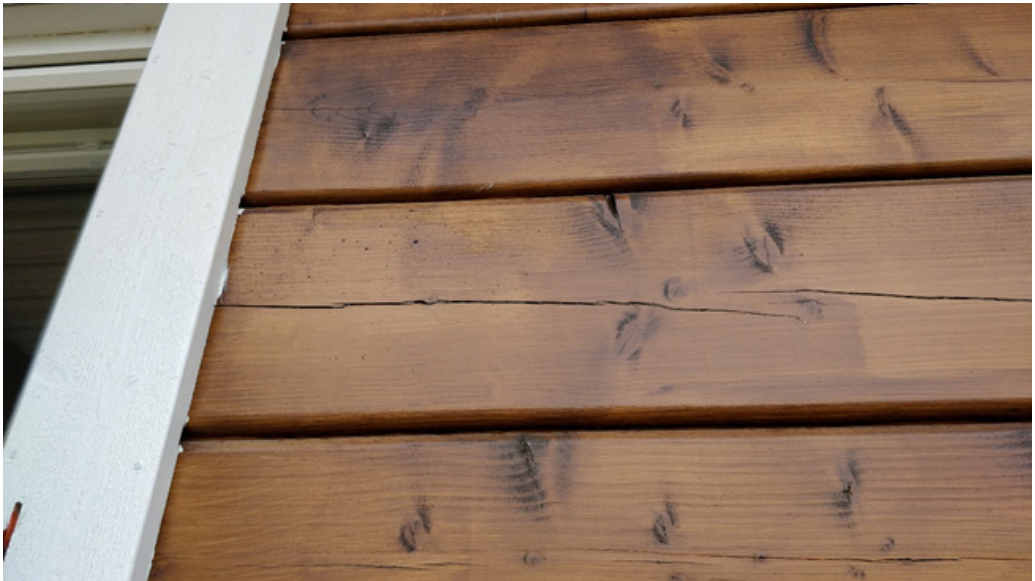
Kuva 114. Eteläseinän suurimpia halkeiluja (Hyvärilä 2018)
