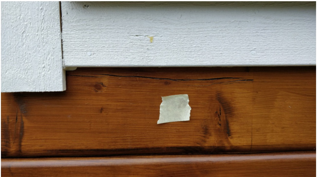
Kuva 116. Itäseinän suurimpia halkeiluja (Hyvärilä 2018)
