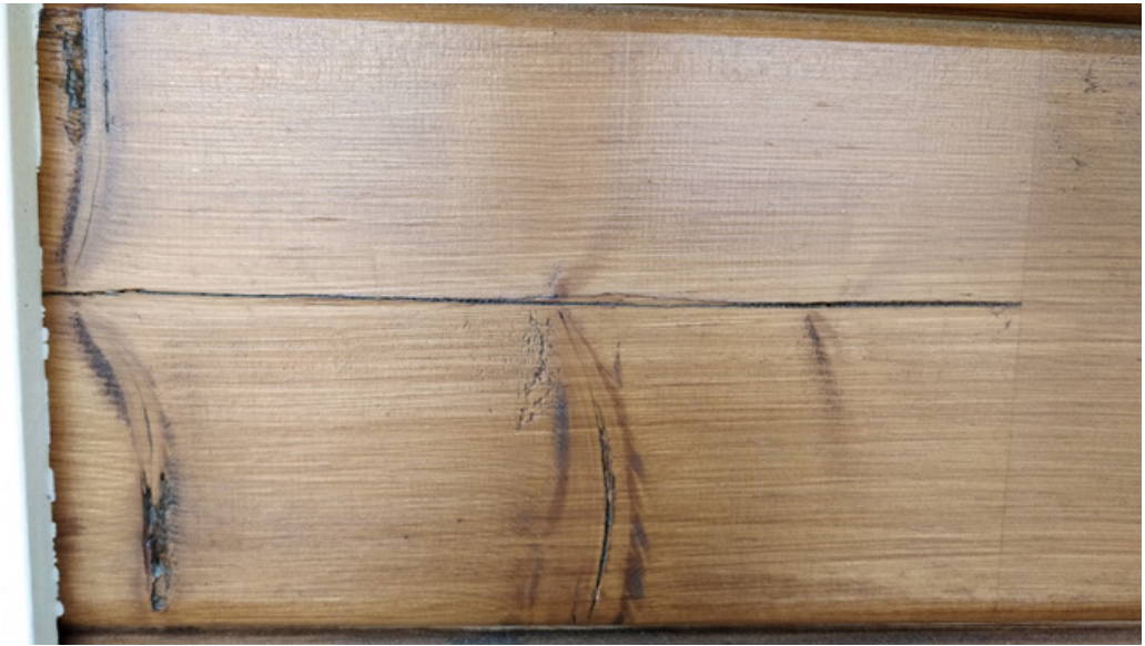
Kuva 117. Pohjoisseinän suurimpia halkeiluja (Hyvärilä 2018)
