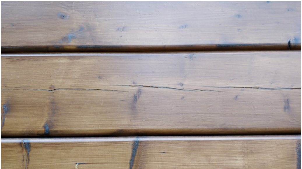
Kuva 118. Länsiseinän suurimpia halkeiluja (Hyvärilä 2018)
