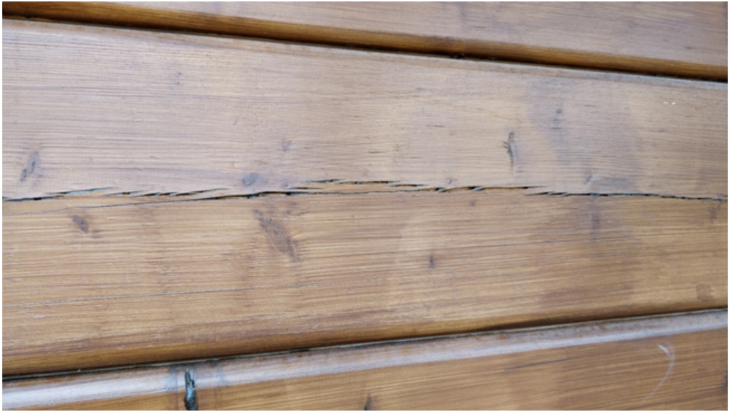
Kuva 113. Eteläseinän suurimpia halkeiluja (Hyvärilä 2018)
