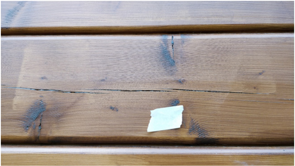
Kuva 115. Itäseinän suurimpia halkeiluja (Hyvärilä 2018)
