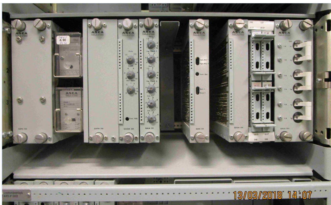
Kuva 23. Turbiinin syöttövesijärjestelmän säätöpiiri, joka on rakennettu Combitrol-toimintayksiköistä. (Kuva: Jarmo Kananen)
