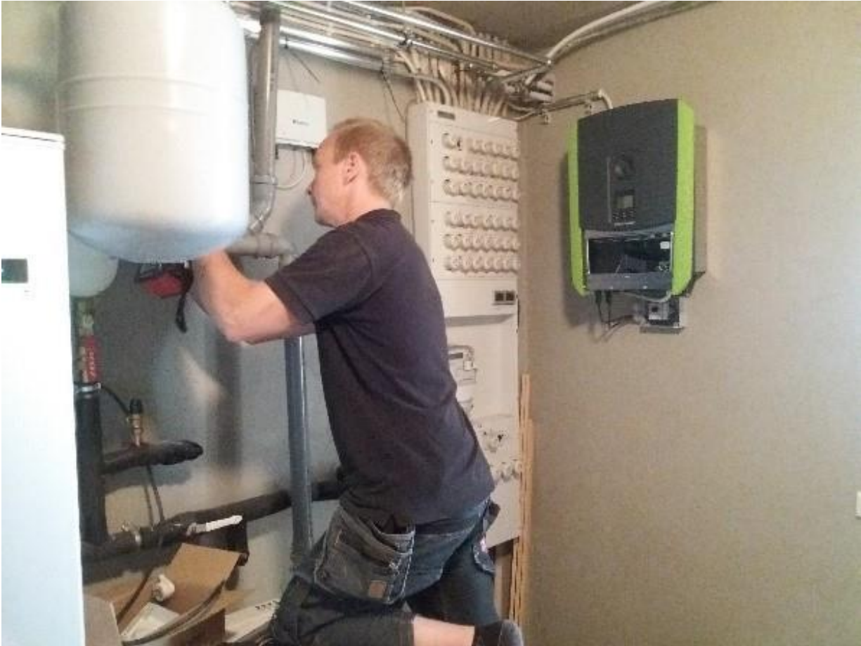
Kuva 1. Sähkömies asensi sähköpääkeskukseen energianseurantajärjestelmän ja vihreän Kostal-merkkisen invertterin (oikealla). Omakotitalon lämmitysmuoto on maalämpöpumppu (Nibe), josta osa näkyy vasemmalla.
