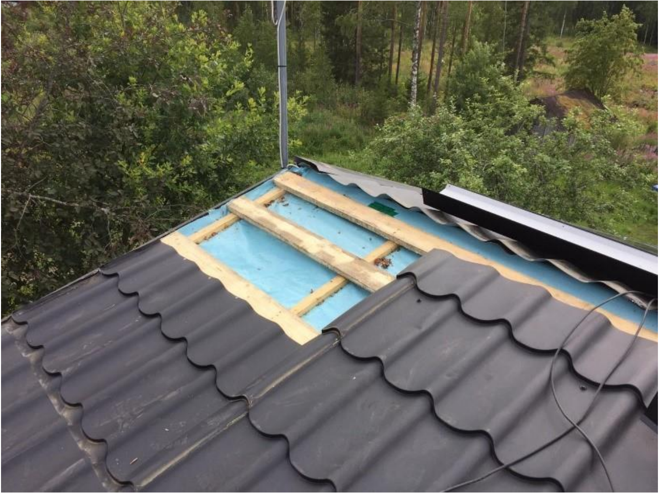
Kuva 8. Paneeleista tulevat sähköjohdot vedettiin harja- ja kattopeltien alta tiiliseinään talon eteläpäättyyn.
