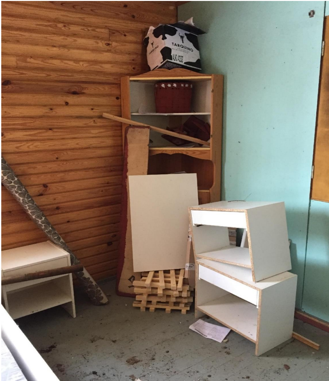
Kuva 6. Puurakenteisen puolen alkupalo.
