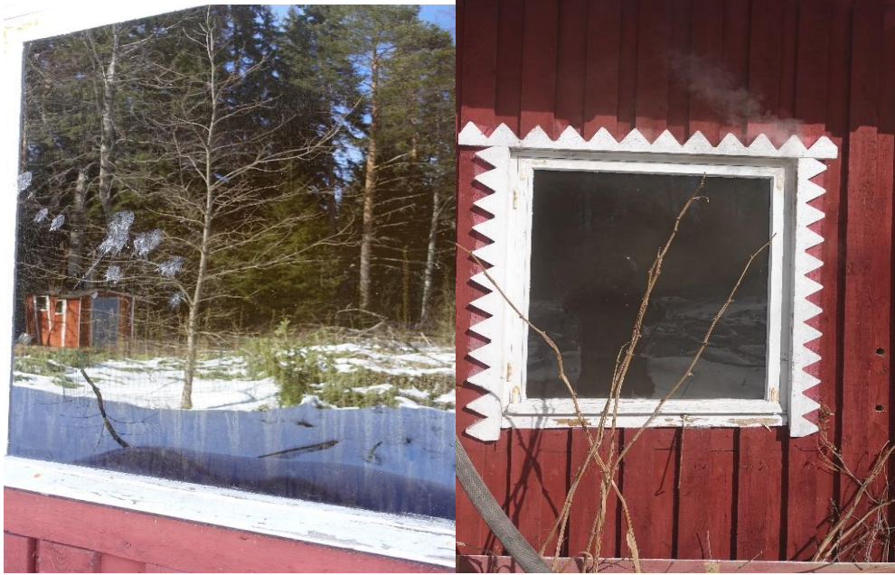
Kuva 20 Valumajäljet ikkunalasissa Kuva 21 Savukiehkura ikkunan pielestä
