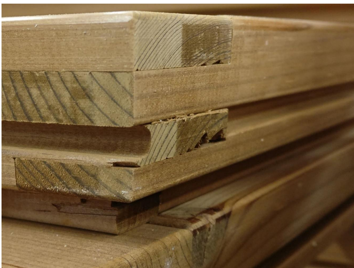
Kuva 10. Repeämiä puitteen päädyissä (Mänty 2019)
