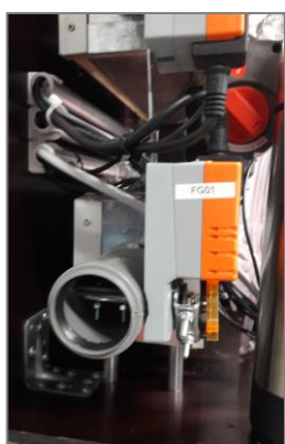
Kuva 24 Pelti ja peltimoottori
