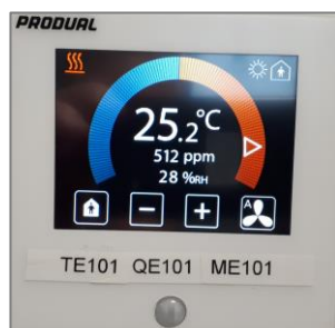
Kuva 46 Huoneyksikkö ROU-S lämmitys tilassa
