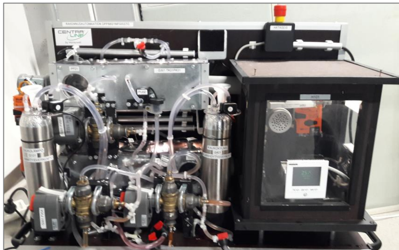
Kuva 22 Kenttätaso Ilmanvaihtokone G301TK01PK01
