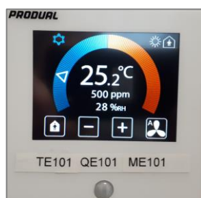
Kuva 47 Huoneyksikkö ROU-S jäähdytys tilassa
