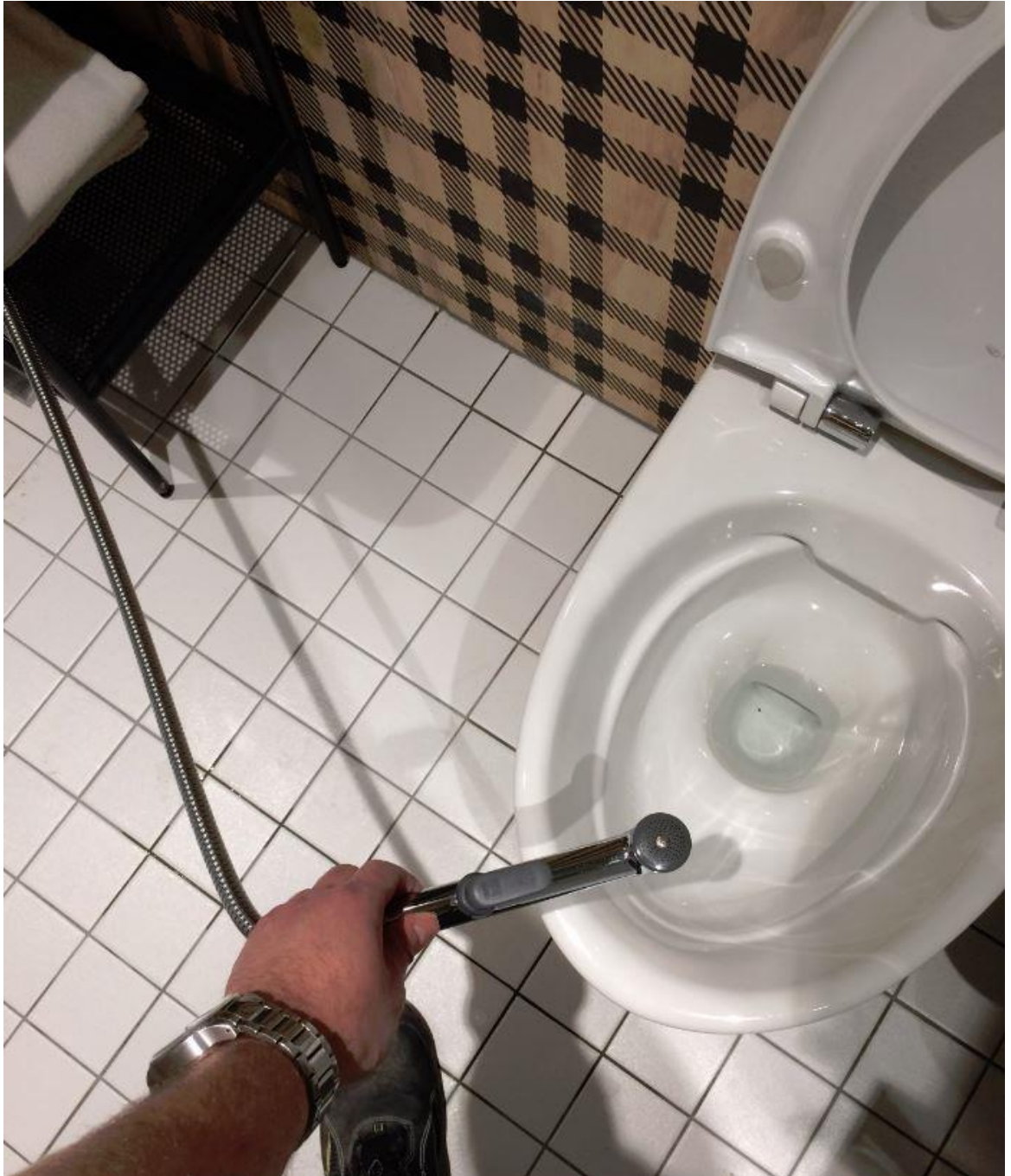
Kuva 9. Itselleluovutuskierrös. Suihkuletkun pituus ei ole riittävä.
