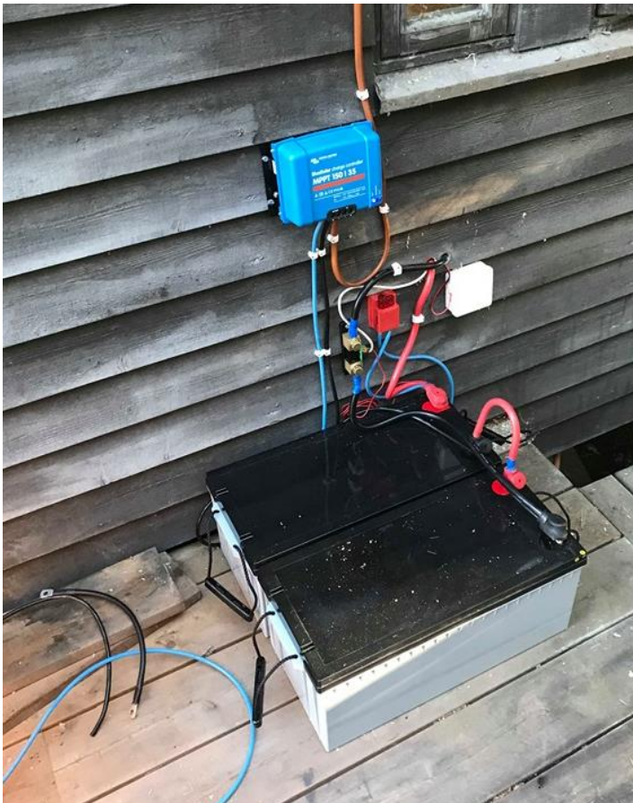
Kuva 10. Ensiasennusta vaikeuttivat puuttuvat kaapelikengät ja johtojen väärä mitoitus.
