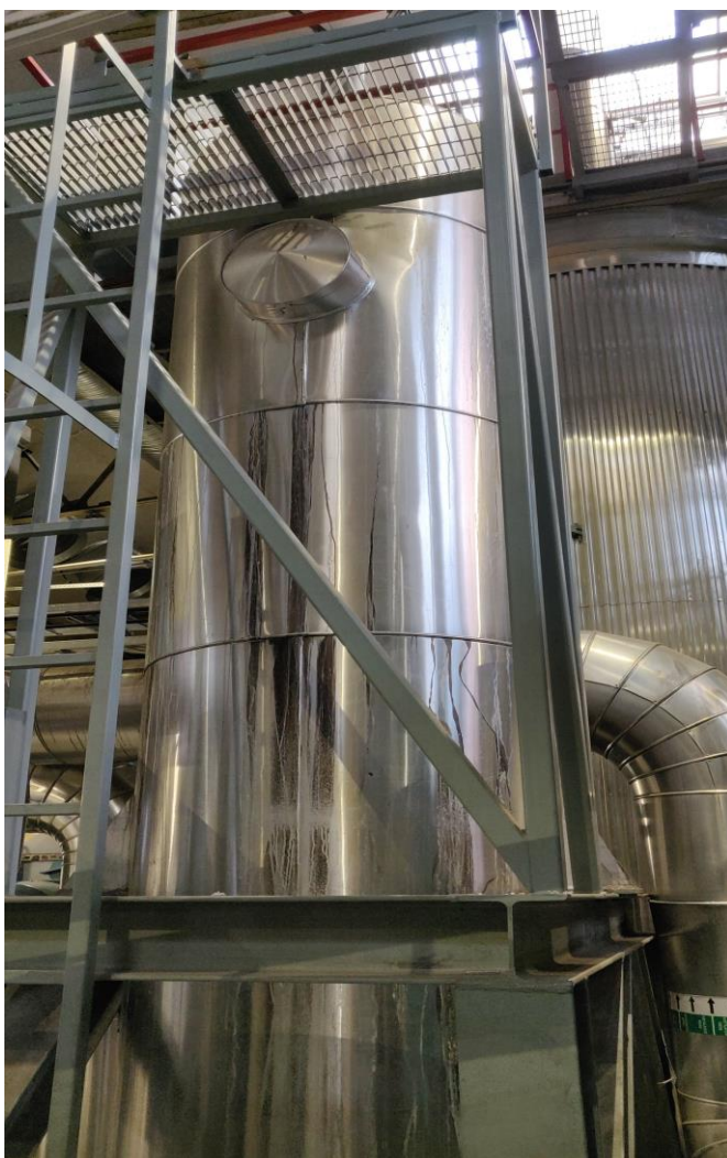
Kuva 11. Kaukolämmönvaihdin, jonka kautta vesi kiertää.
