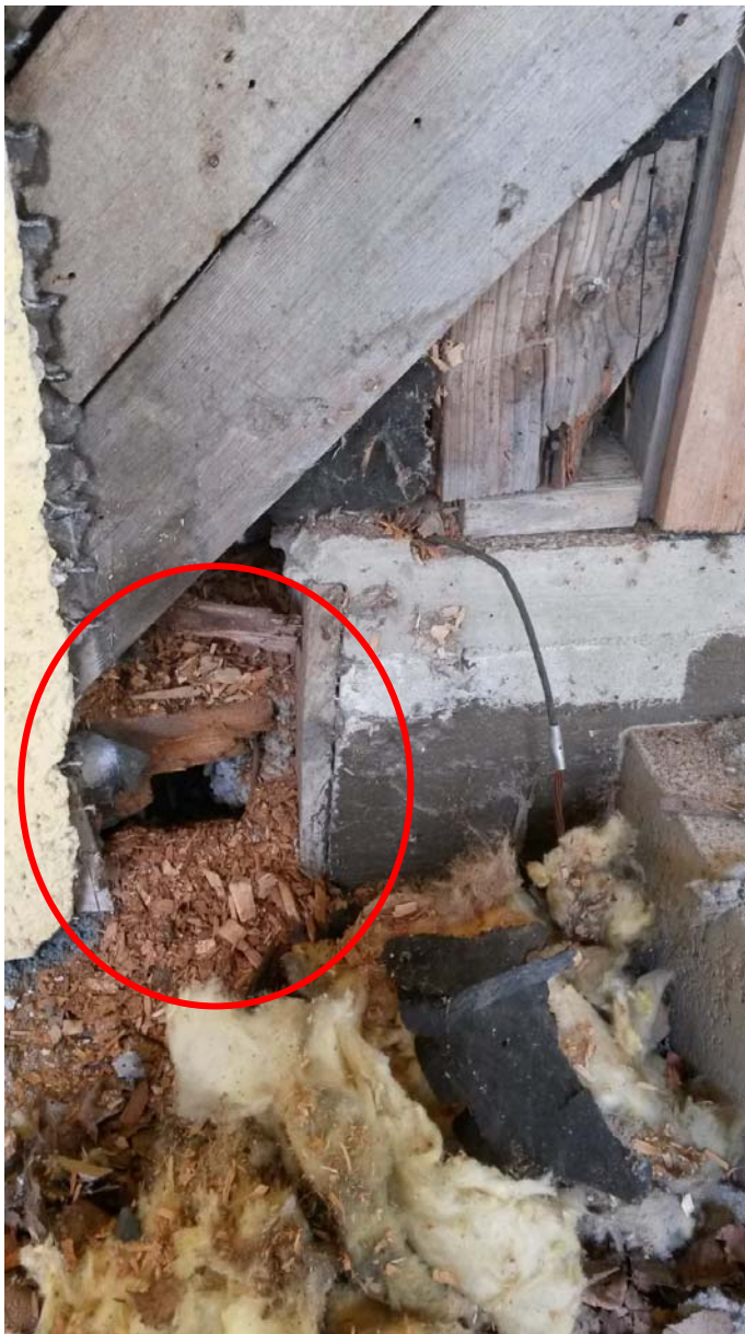
Kuva 9. Salaojien ja kapillaarikatkokerrosten puuttuminen on vahingoittanut vanhan omakotitalon ulkoseinän ala- ja pystyjuoksuja (Lattu 2015)
