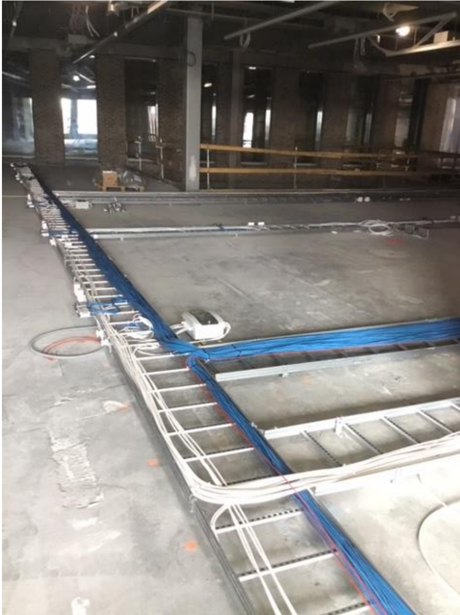
Kuva 9. Valokuva asennuslattian alapuolisista sähkö- ja teleasennuksista.
