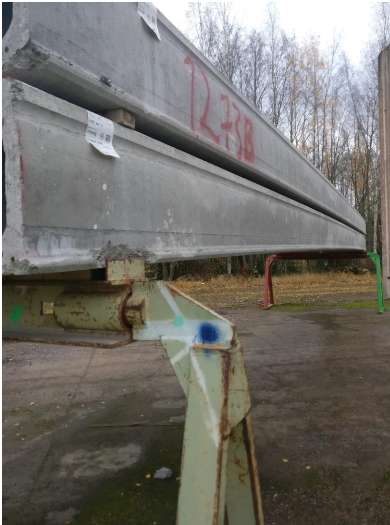
Kuva 2. Ylöspäin kaarevoitunut ontelolaatta säilytyksessä tehtaan pihalla
