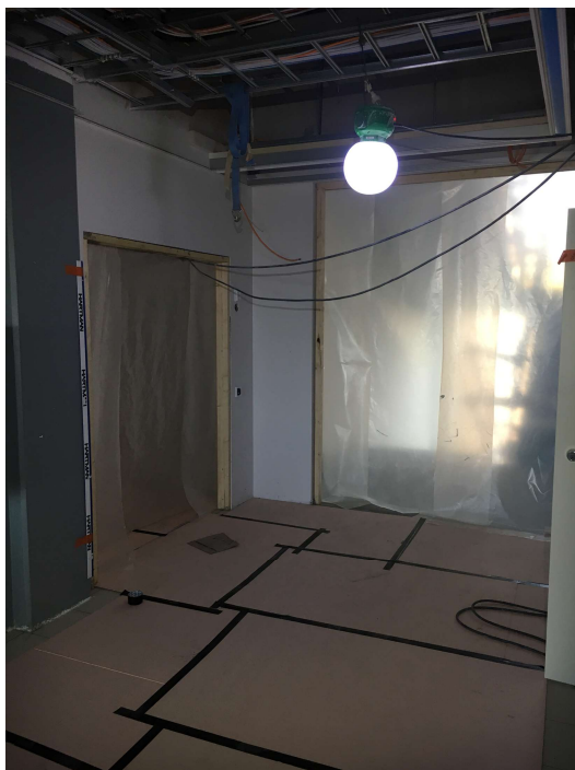
Bild 1. Dammsektionerig inför provkörning av ventilationsystemet. (bilden är inte från ett P1 bygge)
