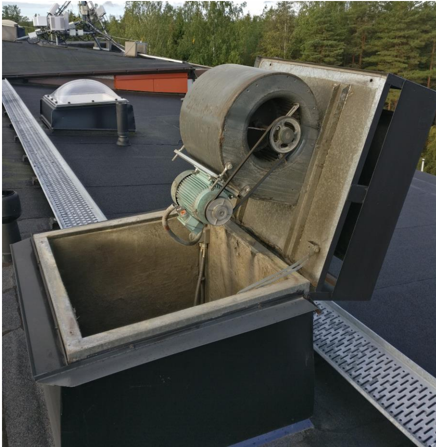
Kuva 11. PP-7, vanha poistopuhallin.
