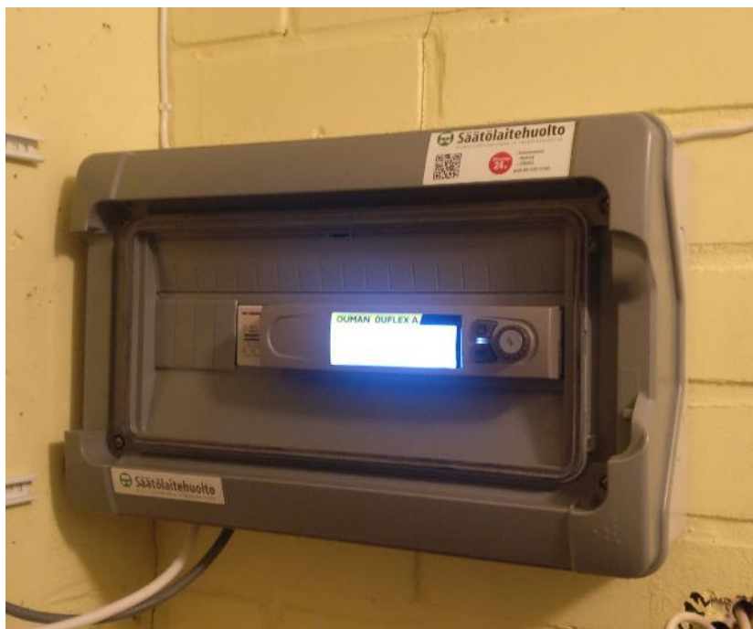
Kuva 14. Ouman Ouflex A asennettuna sähköpääkeskukseen.
