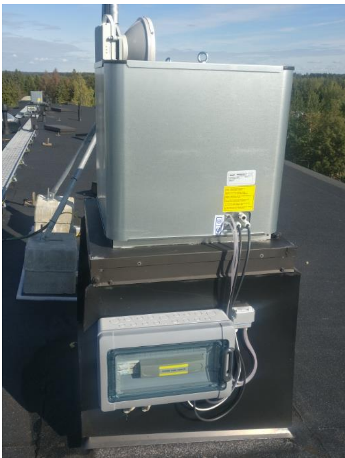
Kuva 15. HiFEK EC -huippumuri ja ohjauslaitteet katolla
