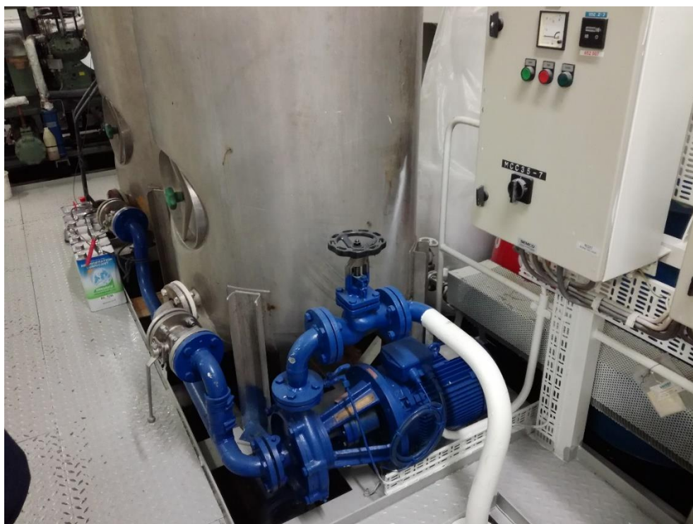
Kuva 7. Vaahtosäiliöt, pumppu ja käyttöpaneeli.
