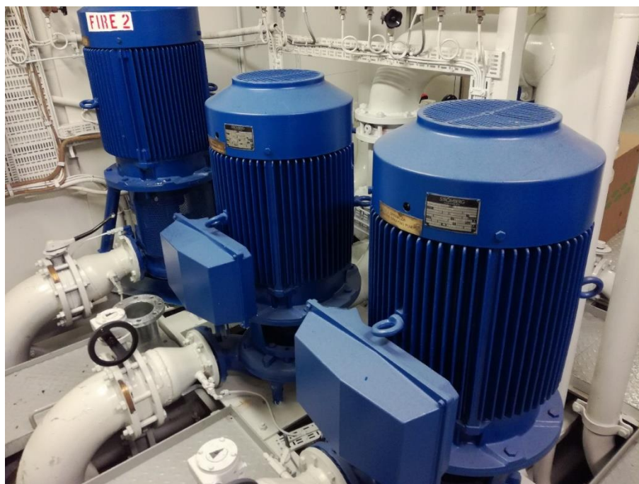
Kuva 6. Sprinkleripumput ja yksi palopumppu.
