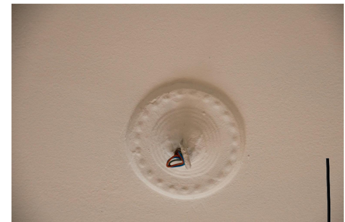
TAAEMMAN TYÖTILAN KATON ROSETTI KAIPAISI VALAISINTA.
