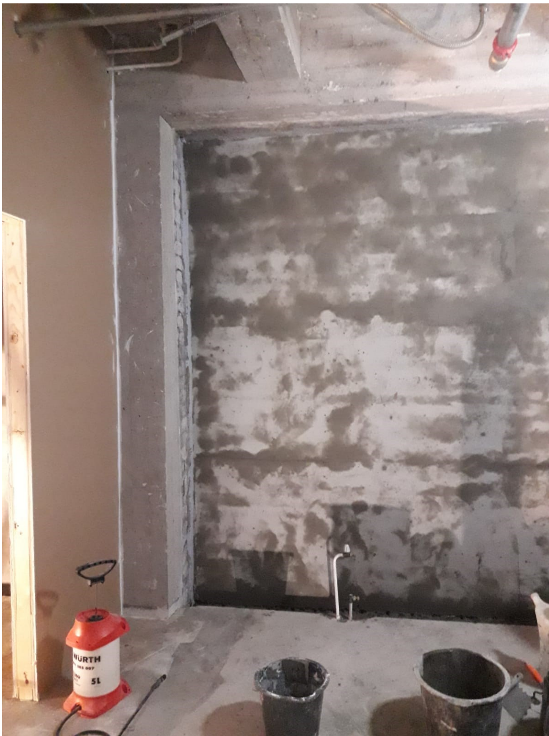
KUVA 9. Maanvastainen seinä ensimmäisen Xypex Concentrate -pintäkäsittelykerroksen jälkeen. Vedeneriste levitettiin mattakosteaan seinään kahtena kerroksena, jonka jälkeen sitä jälkihoidettiin kolme vuorokautta sumutuskastelulla. Seinäpinta tehtiin vedeneristemassalla tasaiseksi, joten erillistä pohjatasoitetta ei tarvittu.
