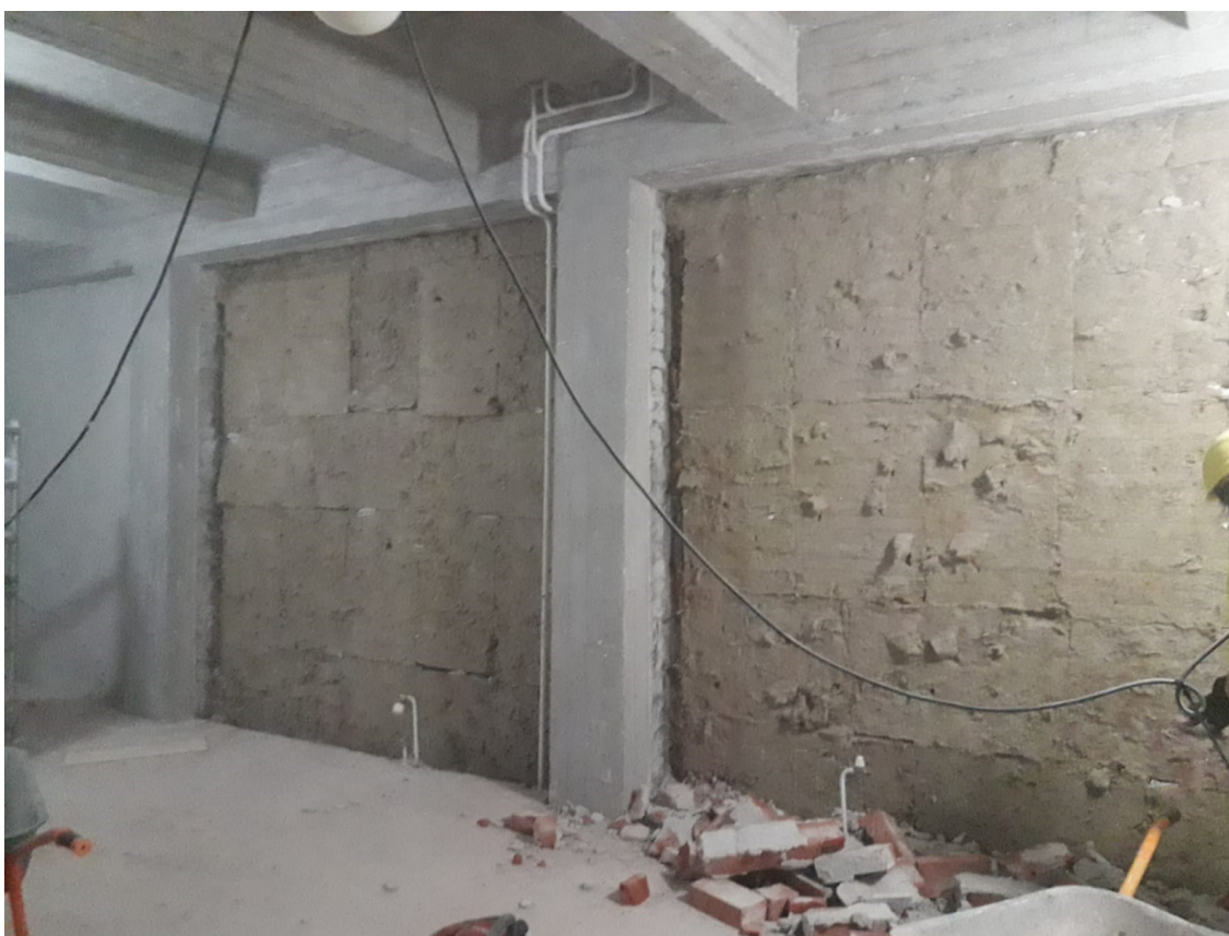
KUVAT 3, 4 ja 5. Puretun tiilimuurauksen takana oli ilmarako ja mineraalivilla. Ylhäällä oikealla oleva kuva on otettu uuden pukuhuoneen puolelta, jossa ilmarako oli noin 400 mm paksu (tiilimuuraus oli tehty pilarin sisäpintaan asti). Mineraalivillan takana näkyy vanha bitumisively (kosteuseriste), joka hiottiin pois haitta-ainepurkuna.
