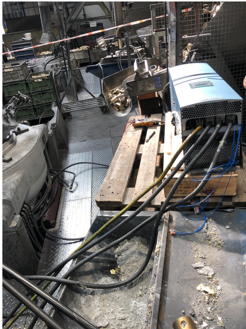
Kuva 7.6 Testitilanne, jossa näkyy uuni ja taajuusmuuttaja
