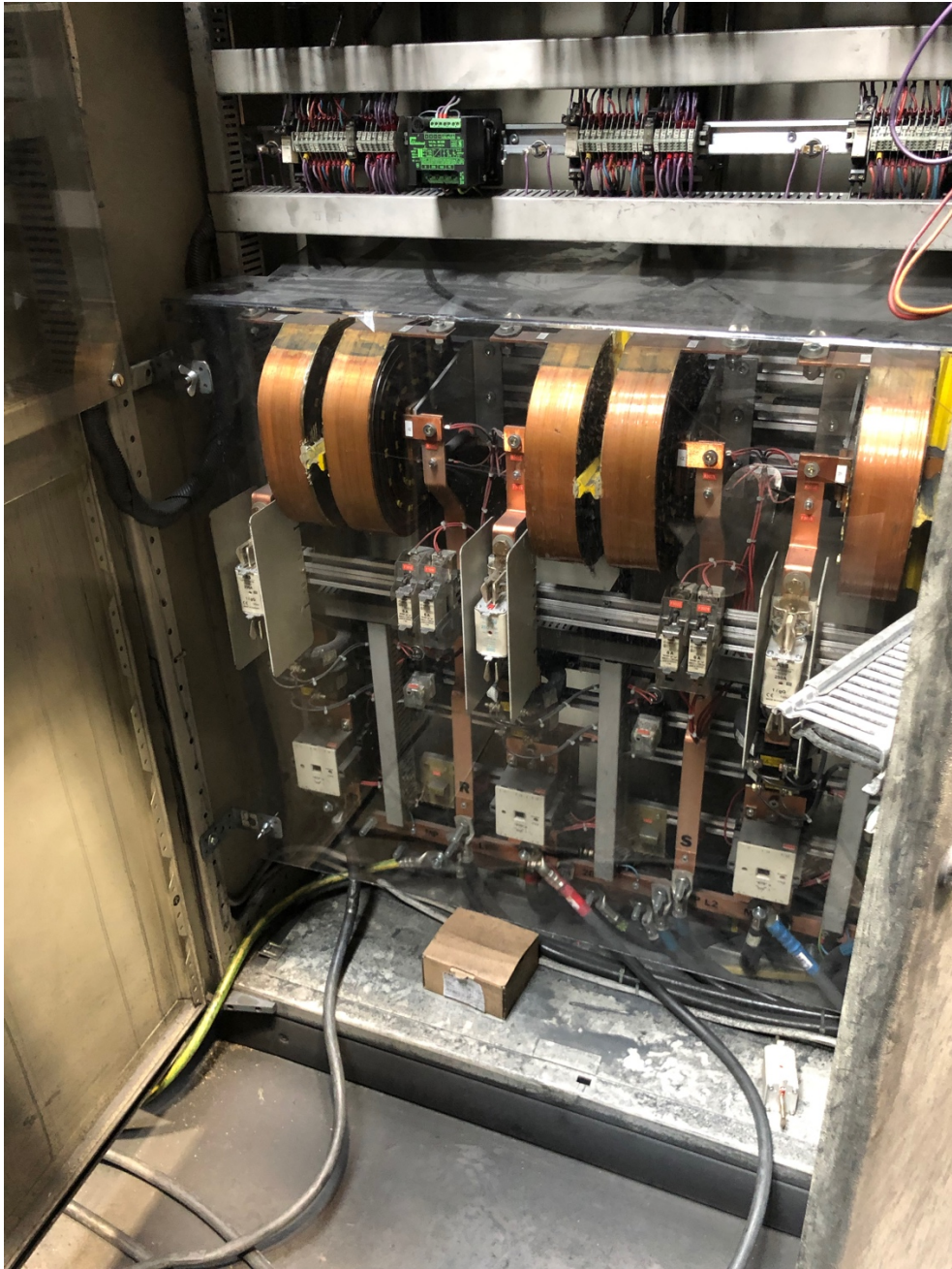
Kuva 7.7 Uunin vanha ohjauskaappi, joka on tarkoitus korvata
