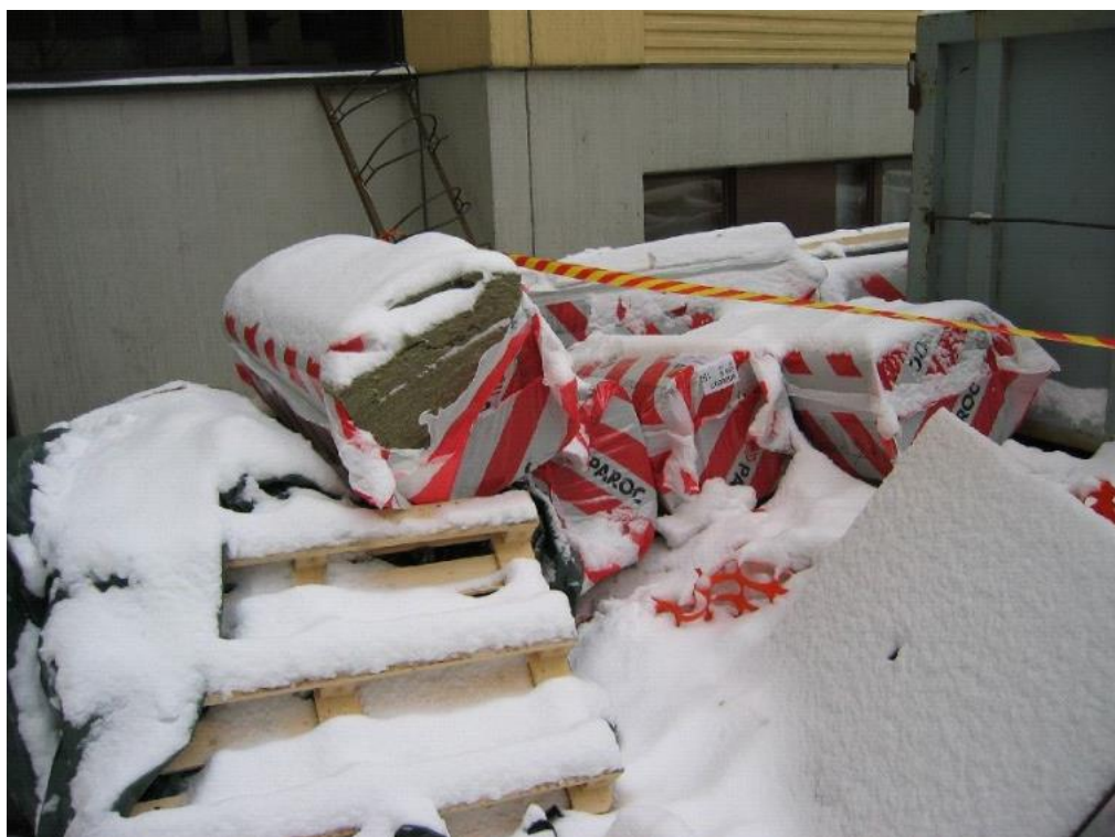
KUVA 4. Esimerkki epäonnistuneesta materiaalien suojauksesta. (www.fise.fi/virhekortti)
