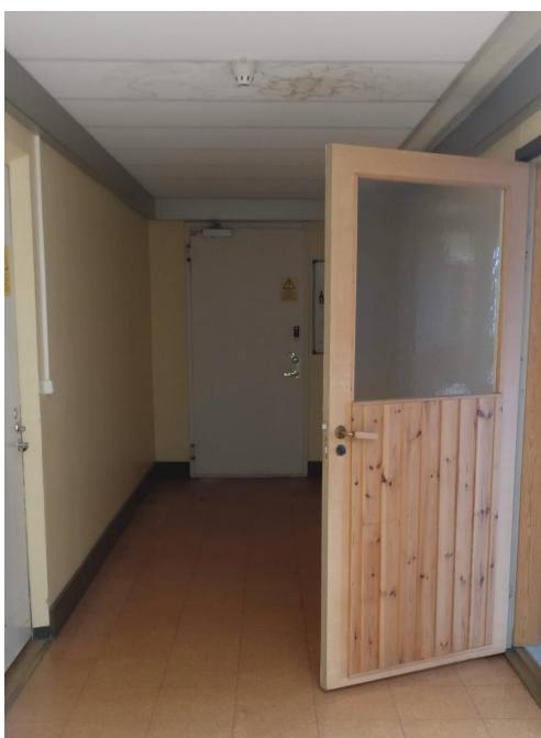
KUVA 3. Kosteutta saanut alakattolevy
