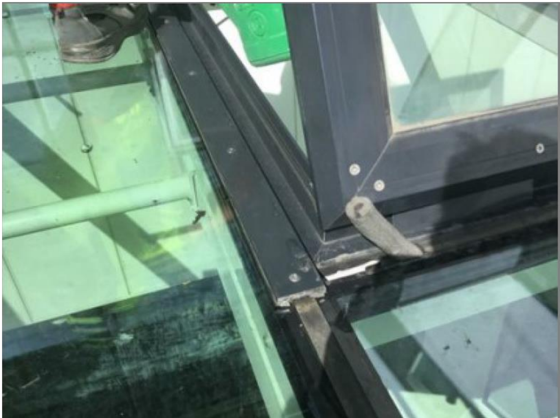
KUVA 14. Savunpoistoluukun karmin vedenpoistoreikä näkyy nostetun solumuovieristeen kohdalla.
