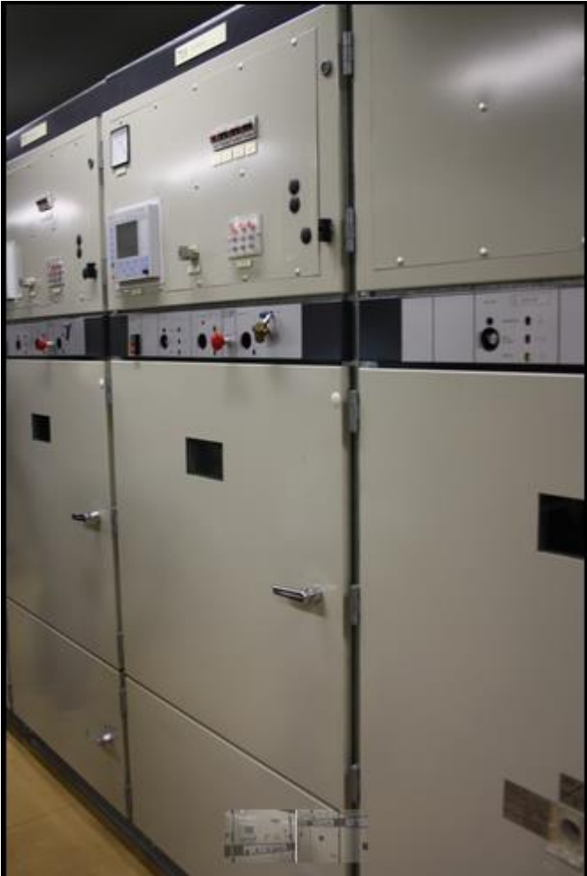
KUVA 3. Kytkinlaitoskojeiston kennostoa. Kuva: Halme 2019
