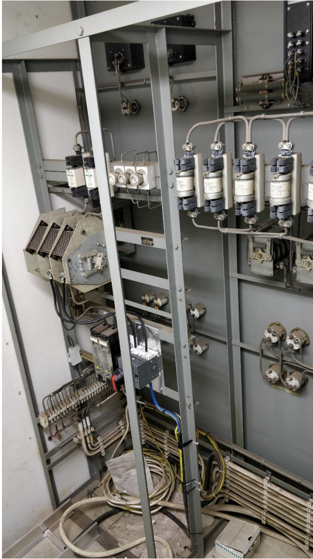
Kuvio 6. Tasasähkökeskuksen puutteellinen kosketussuojaus
