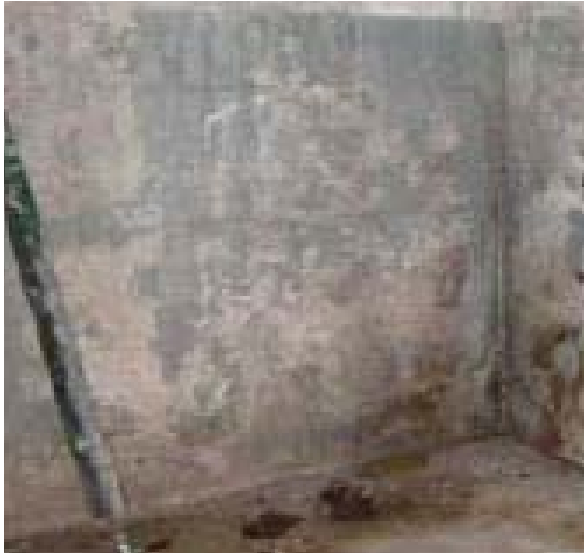
Kuva 19. Kellaritilojen seinärakenteiden läpi tuleva kosteus aiheuttaa pinnoite vauriota seinien sisäpuolella (4.)
