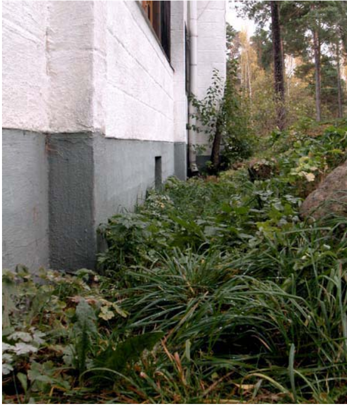
Kuva 10. Monin paikoin maa viettää taloon päin. Kuva Honkalasta. (5.)
