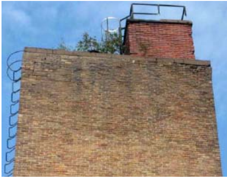
Kuva 21. Lämpökeskuksen tornin yläosan rapautuminen on edennyt pitkälle (4).
