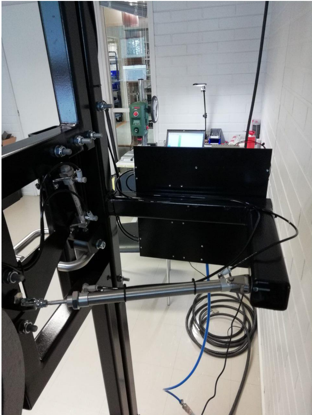
Kuva 19. Oven kahvan painosylinteri ja oven avaussylinteri
