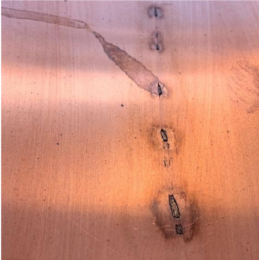
Kuva 28. Laattaunin eristyksen kiinnitykset pudonneet tuotteeseen.
