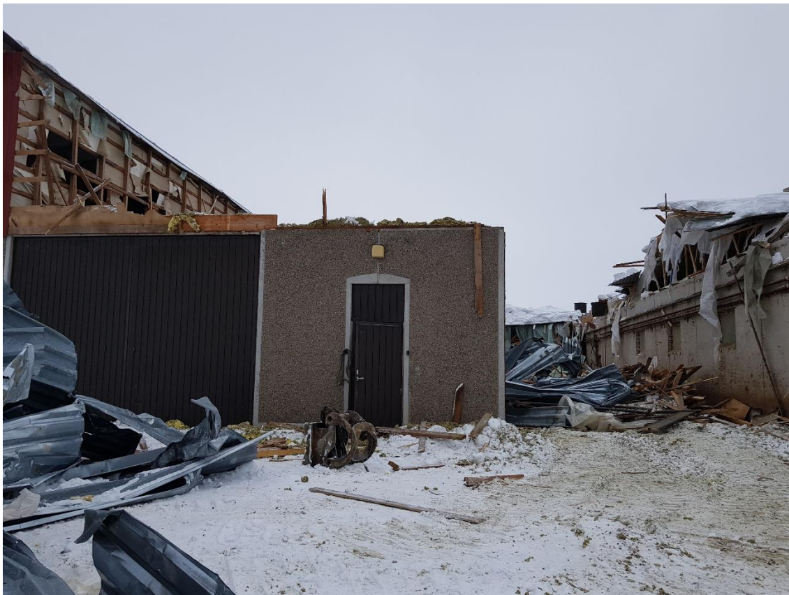
Kuva 3. Porsasmyllyn romahdustyömaan pohjoispuolta, (Lehtinen, 2019).
