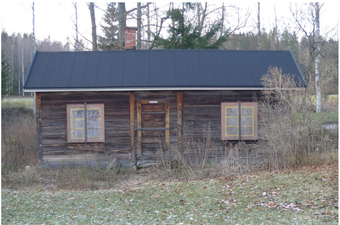
Kasvillisuus on levinnyt liian lähelle useimpia rakennuksia.
