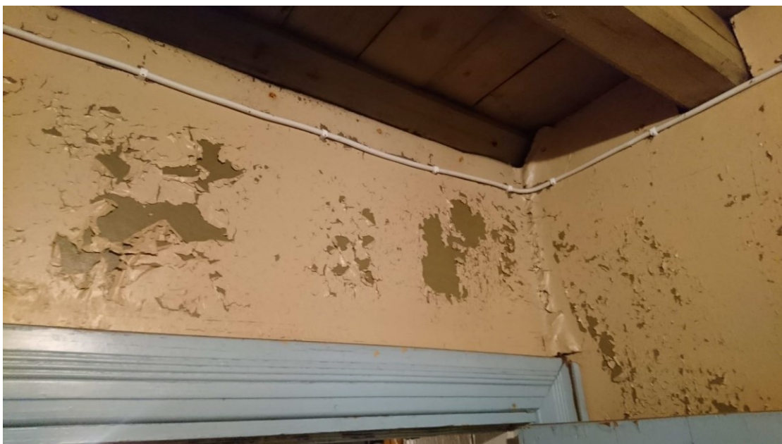
Kuva 26. Laajennuksen eteisen seinien maalipinta hilseilee irti. (Teresa Jalander)
