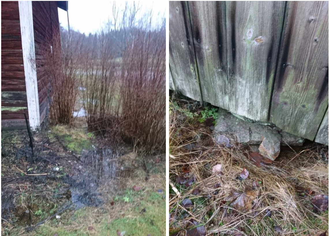
Sadevesi lammikoituu pahimmillaan jopa rakennusten perustuksiin.
