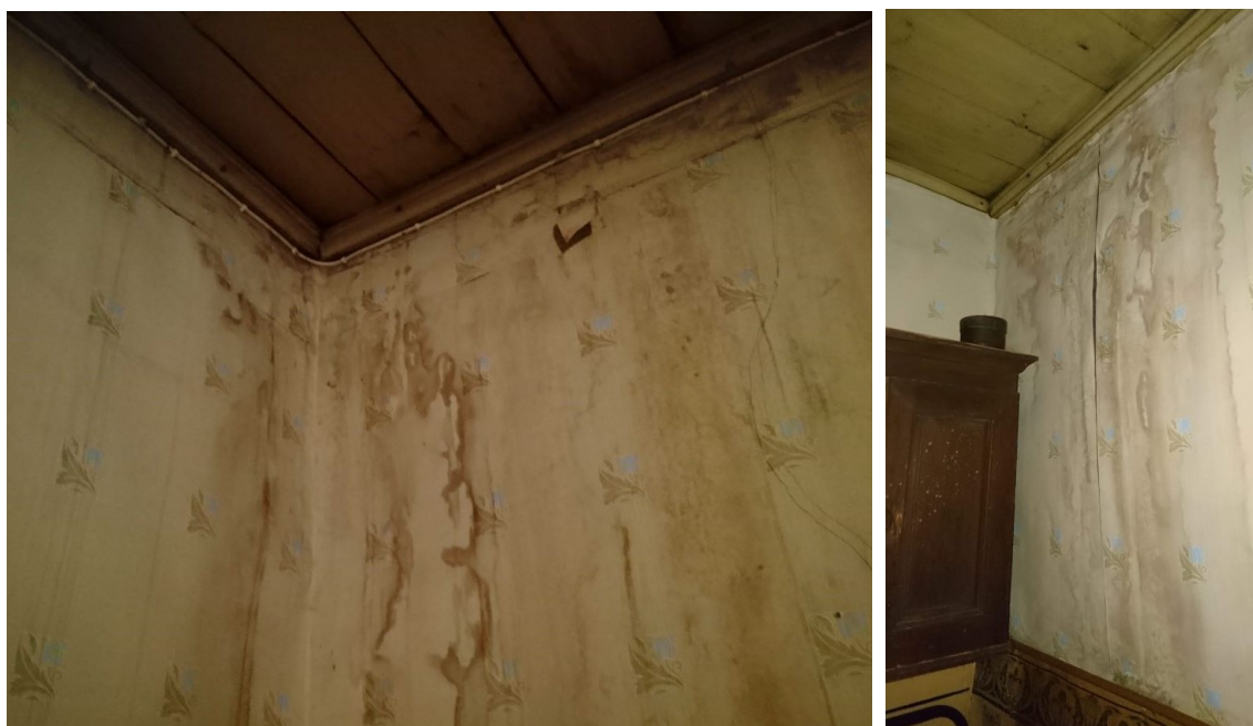
Kuva 15. ja kuva 16. Vesikaton vuotamisen aiheuttamia kosteusvaurioita seinissä. (Teresa Jalander)
