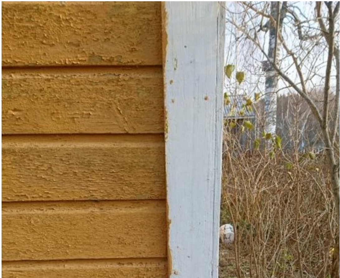
Ulkoerhouksen maalipinta hilseilee irti alustastaan.
