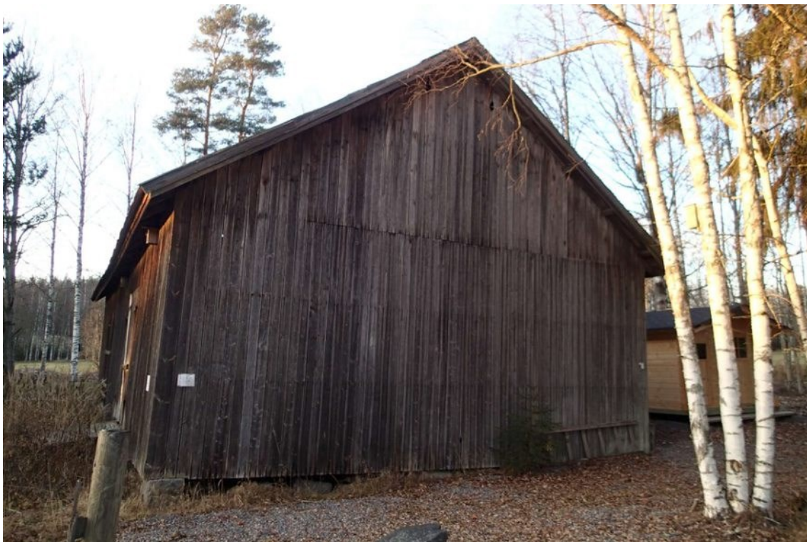
Kuva 11. Painunut nurkka vaikuttaa myös päätyseinään. (Petteri Patolinna)
