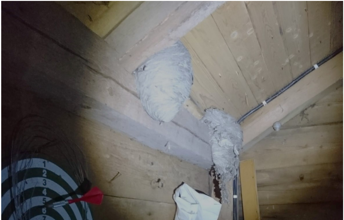
Suuria ampiaispesiviä päärakennuksen varastossa.
