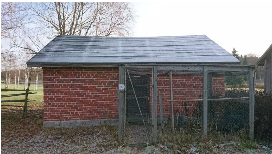
Kuva 8. Sikalan vesikaton harja on silminnähdyn notkolla. (Teresa Jalander)
