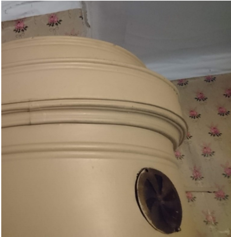
Tähtiventtiili pönttöuunin yläosassa päärakennuksen makuuhuoneessa.
