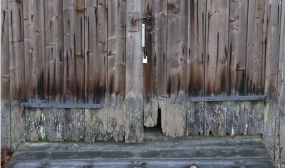
Kuva 7. Pariovien alareuna on kärsinyt kosteusvaurioista. (Teresa Jalander)
