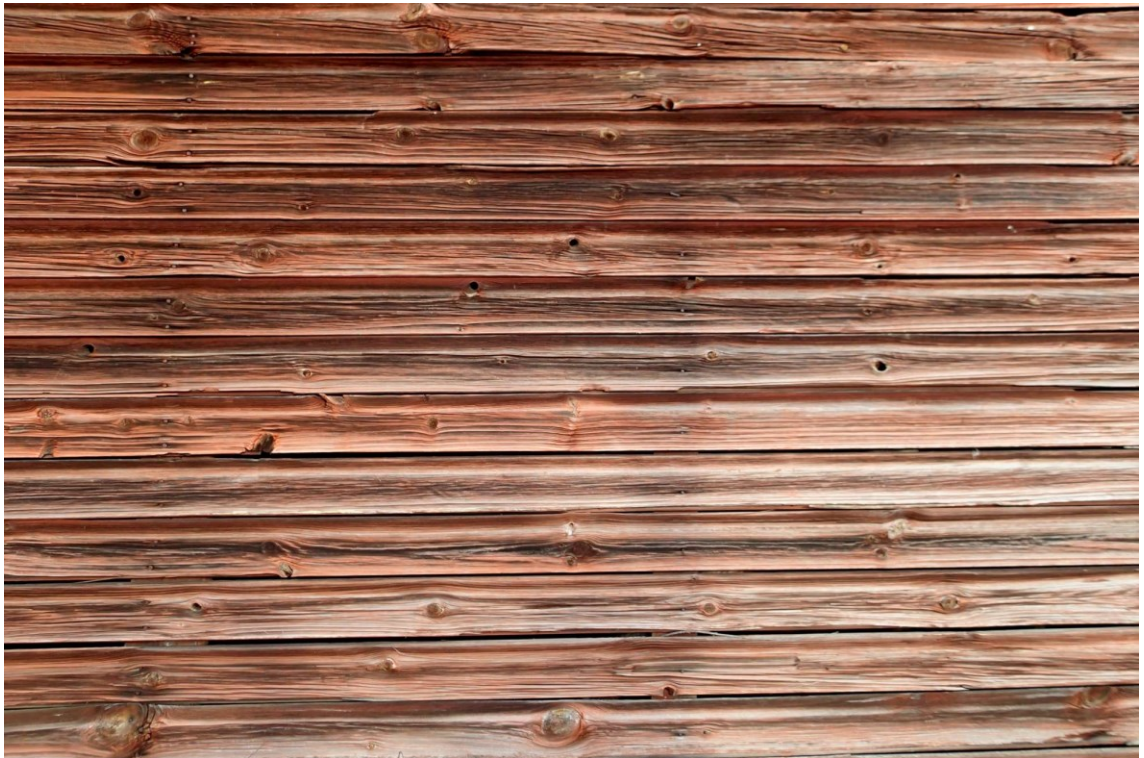
Aitan eteläseinän laudoitus on voimakkaasti rapautunut.
