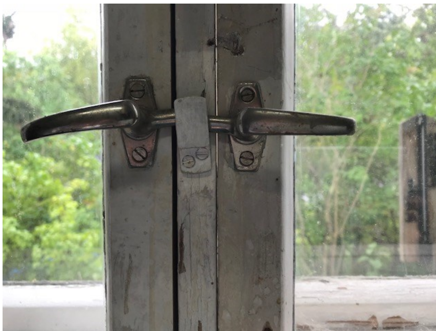
Kuva 8. Kun valo tulee sisään myös ikkunankarmin ja pukan välistä, on lämpöhukan minimoimiseksi hyvä tilkitä välit talveksi. Tuloilmalle tulee kuitenkin jättää reitti avoimeksi sisäpuutteen yläreunaan, mikäli tuloilmalle ei ole varattu muuta reittiä.
