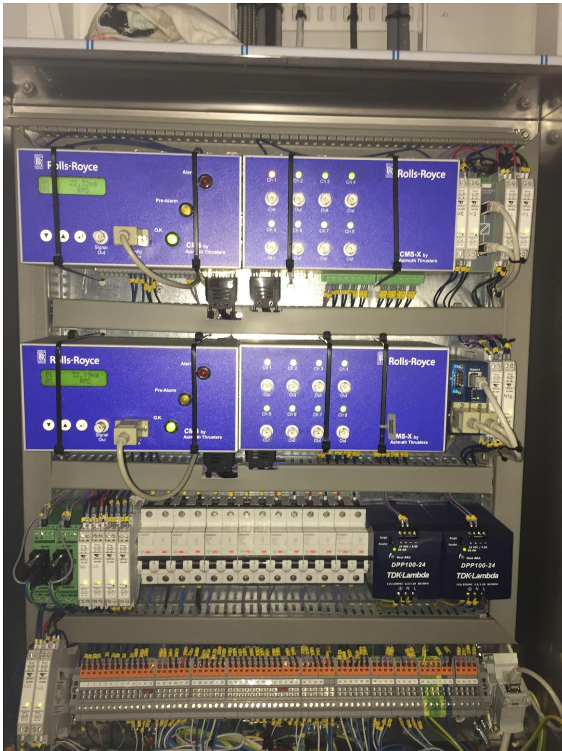
Kuva 17. DTECT X1 mittalaite CMU-kaapissa. (Kongsberg Maritime Finland Oy, 2019)
