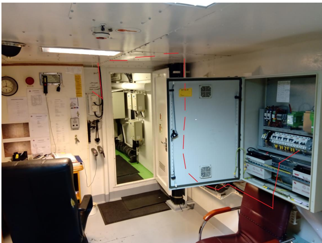
Kuva 9. Konevalvomon UPS250-DC -sähkökaappi. Punainen viiva kuvaa järjestelmän syöttökaapelin reittiä konevalvomosta konetopille. Kuva: Harju 2019.
