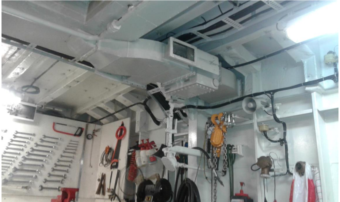
Kuva 2. Castorin koneosaston verstaan tuloilmakanava. Kuva: Harju 2019.
