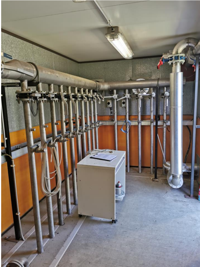
Kuva 7. Sisäkuva Domargårdin kaasupumppaamosta
