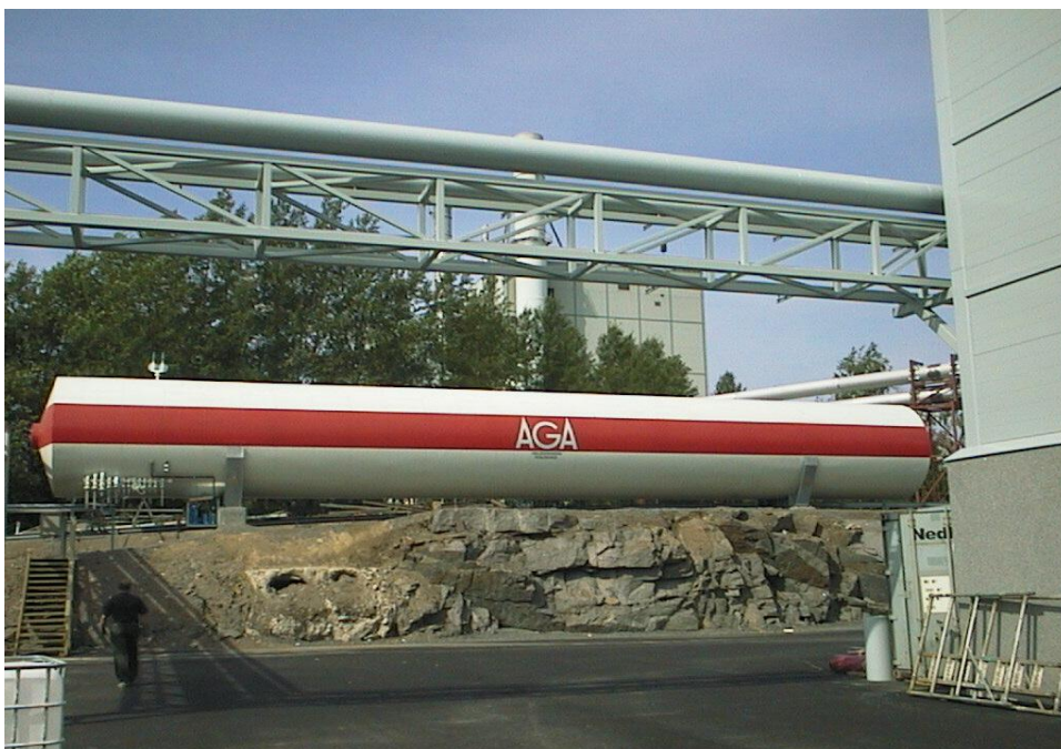
Kuva 2: Varastointisäiliö (Kuva: Gav Group Oy)
