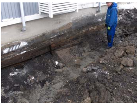
Kuva 10: Ulkopuolelle anturaan jätetty muottilaudoitus
