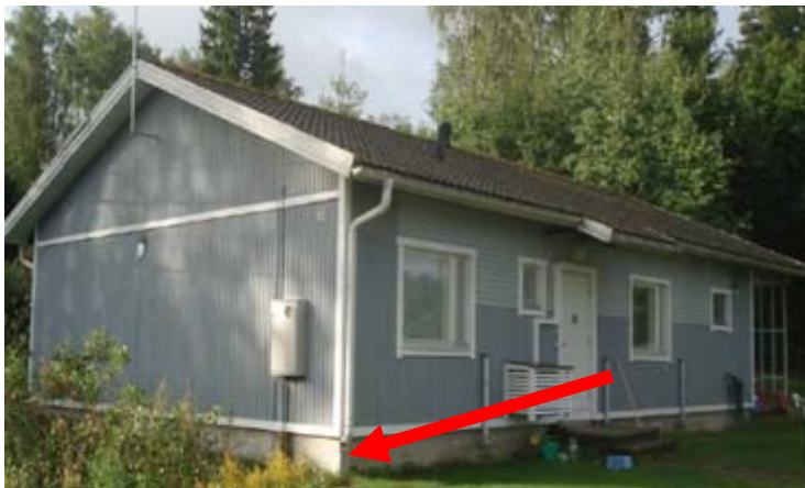
Kuva 3: Kattovedet kerääntyivät suoraan sokkelin viereen (Kuva: Tuomo Pitsinki)
