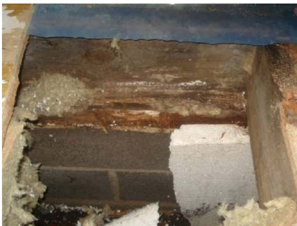
Kuva 12: Alapohjarakenteiden mikrobi- ja lahovaurioita (Kuva: Tuomo Pitsinki)
