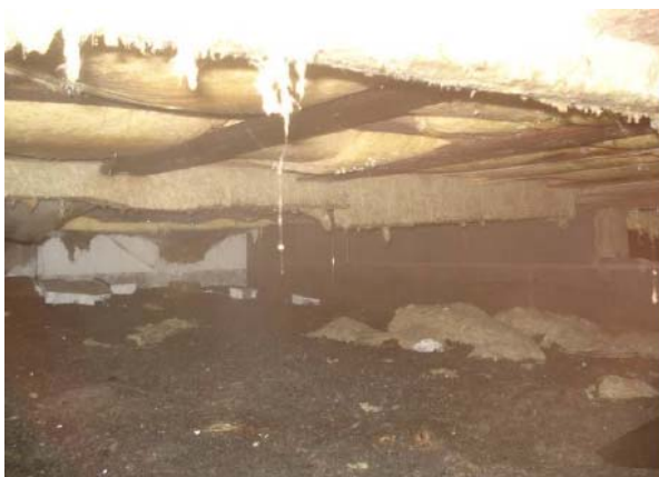
Kuva 11: Alapohjarakenteiden mikrobi- ja lahovaurioita (Kuva: Tuomo Pitsinki)
