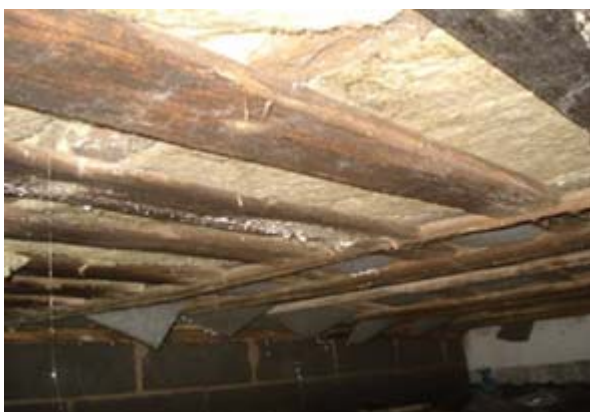
Kuva 2: Vaurioitunut alapohjarakenne, jossa on mikrobikasvustoa ja lahovaurioita (Kuva: Tuomo Pitsinki)
