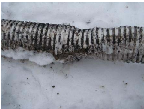
Kuva 5: Vaurioitunut vanha salaojaputki
