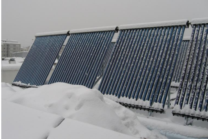
Kuvio 7. Lämpöenergiaa tuottavat tyhjiöputkikeräimet sijaitsevat rakennuksen katolla. Kuva: Emma Suokas.
