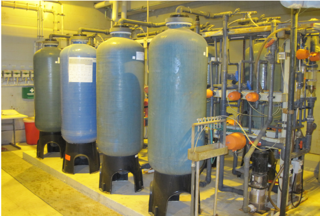
KUVA 3. Pursialan voimalaitoksen ioninvaihtolaitos (Pursialan voimalaitos).
