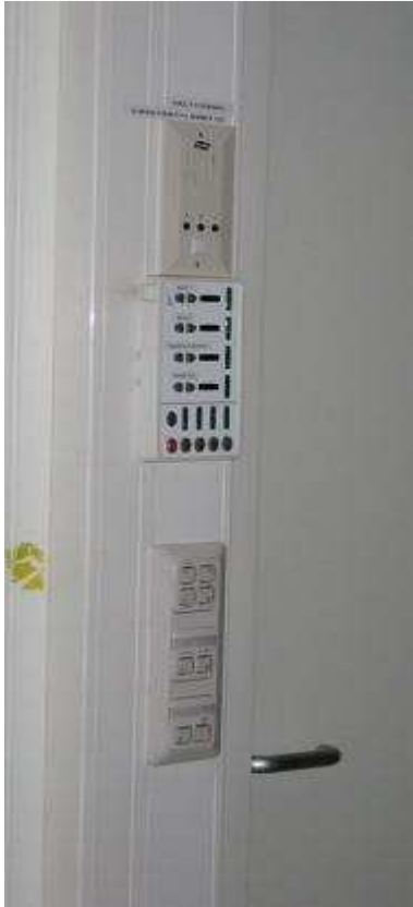
S-KUVA 13. Valaistuksen ohjaustaulu.
