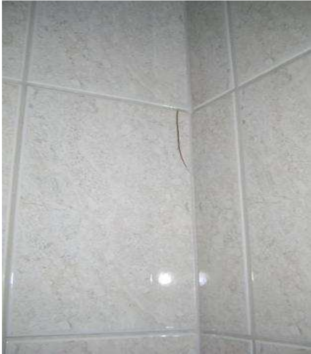
R-KUVA 11. Seinälaitoituksessa yksittäinen halkeama.
