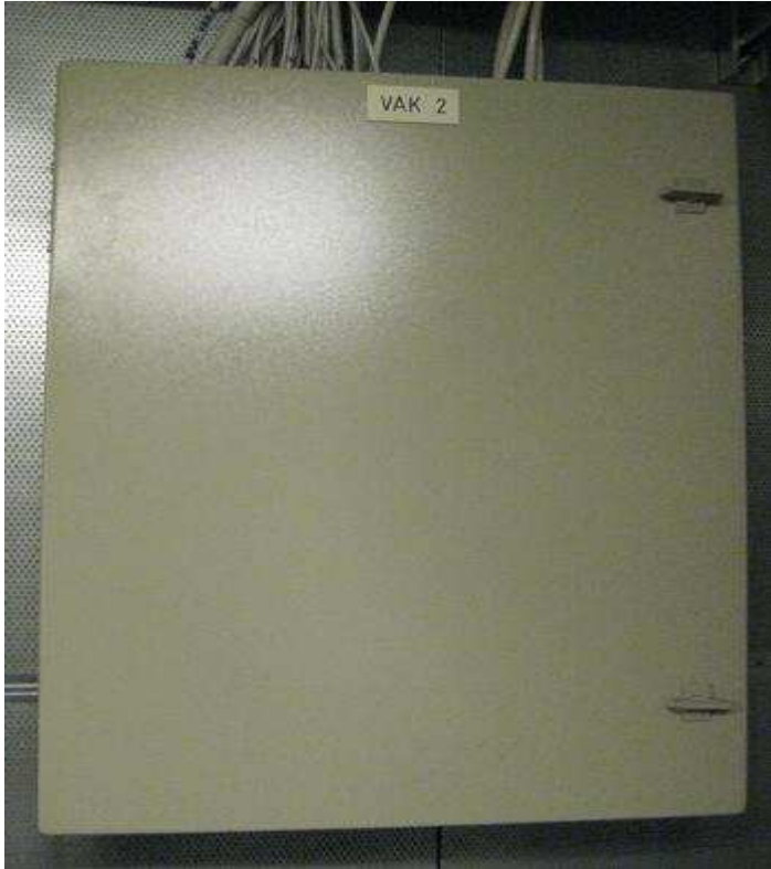
S-KUVA 21. Rakennusautomaatiojärjestelmä alakeskus IV- konehuoneessa.
