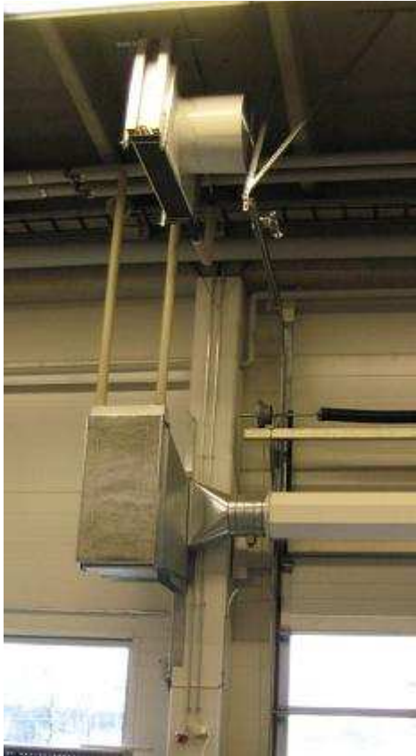
LVI-KUVA 5. Yleiskuva kiertoilmapuhallinpatterista ja oviverhopuhaltimesta.
