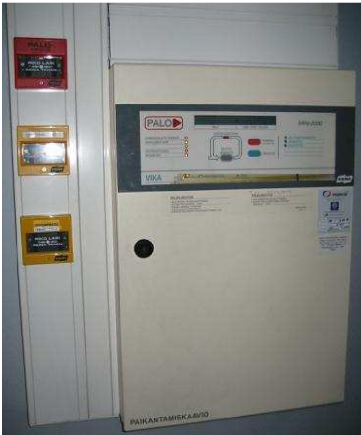
S-KUVA 18. Paloilmoitinkeskus pääsisäänkäynnin vieressä.
