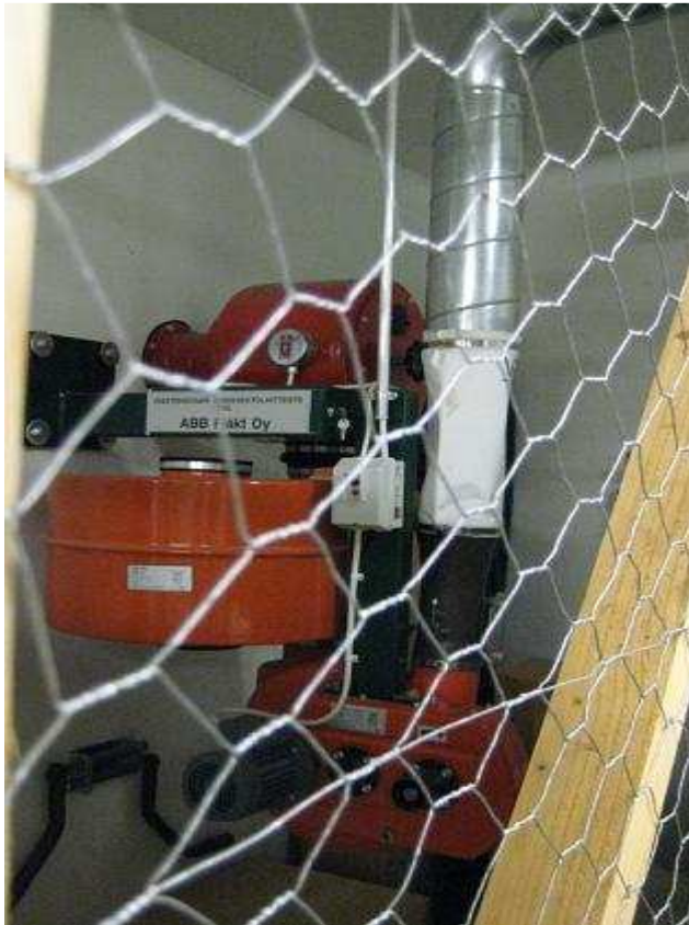
LVI-KUVA 8. Väestönsuojan ilmanvaihtolaitteet.
