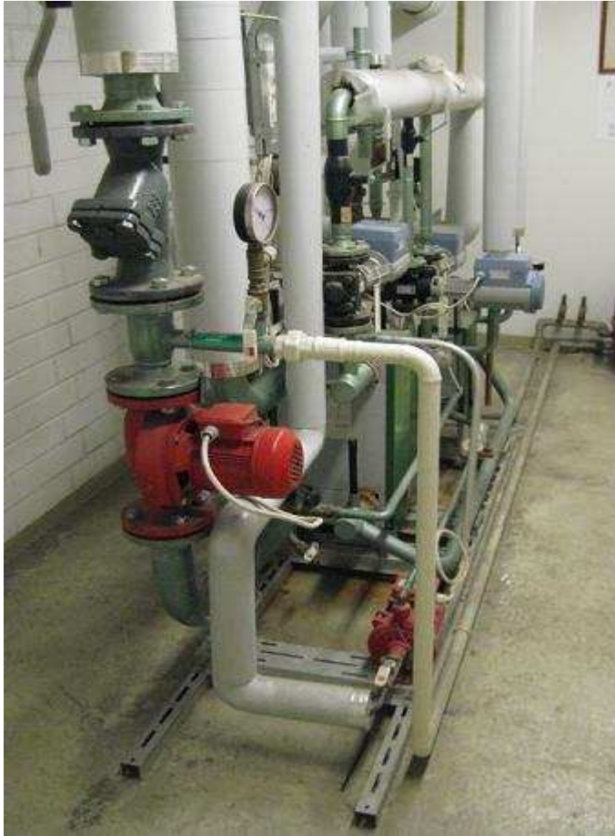
LVI-KUVA 1. Yleiskuva lämmönjakuhuoneen laitteista.
