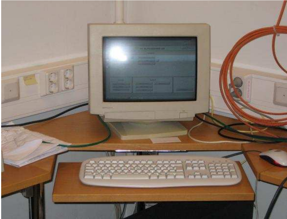
S-KUVA 19. Valvomo huoneen vanha pc.
