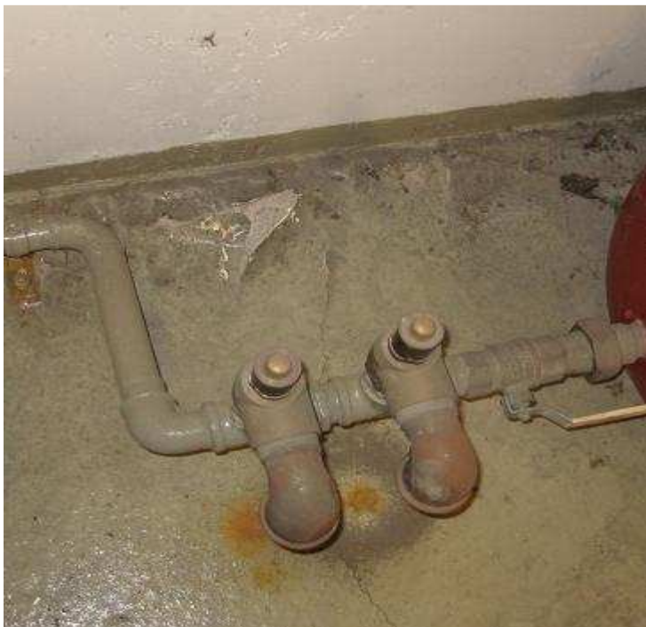
R-KUVA 10. Lämmönjakohuoneen lattian pintarakenteen hilseily.
