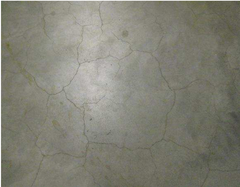
R-KUVA 4. Varasto-osan lattiarakenteen halkeilu.
