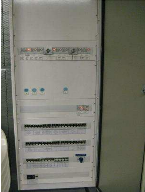
S-KUVA 5. IV- konehuoneen keskus.
