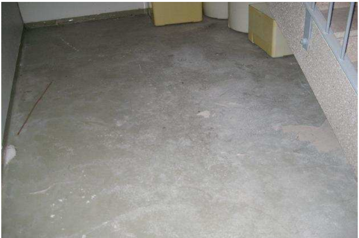
R-KUVA 8. Kylmä porrashuoneen lattiapinnoitteen hilseily.
