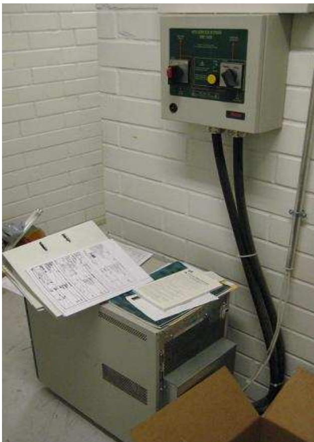
S-KUVA 16. UPS- laitteisto pääkeskustilassa.
