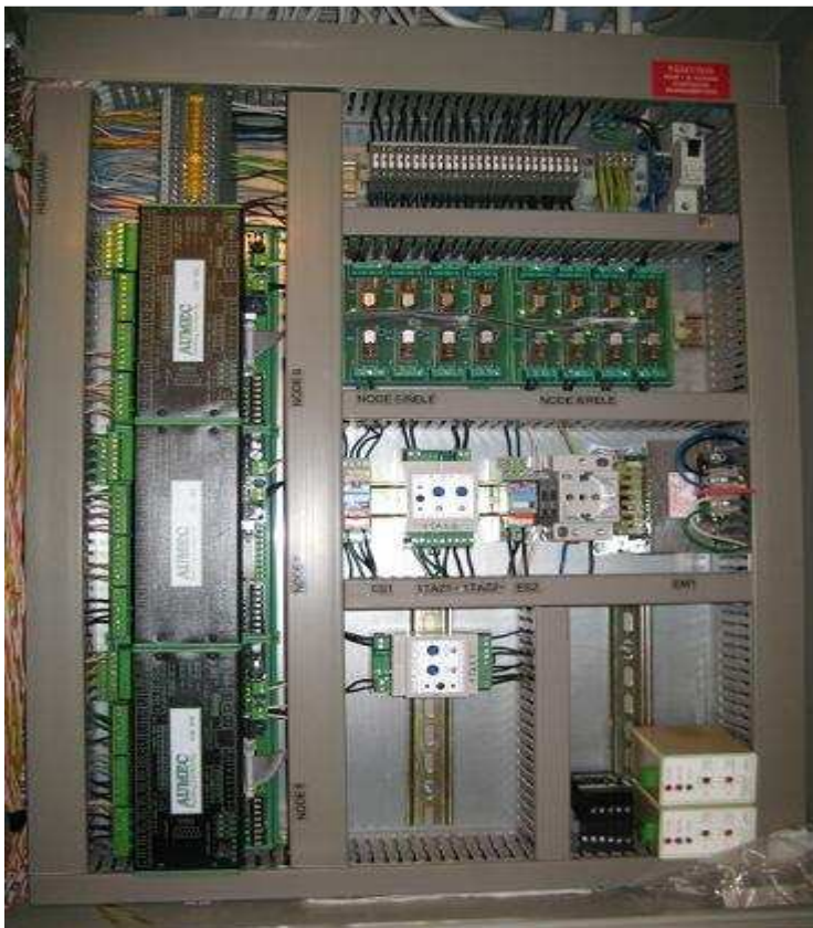
S-KUVA 22. Rakennusautomaatiojärjestelmä alakeskus IV- konehuoneessa.
