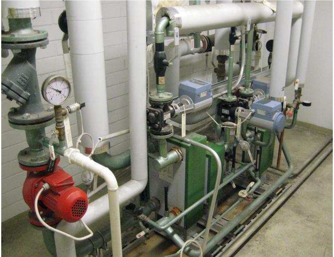
S-KUVA 23. Rakennusautomaatiojärjestelmän kenttälaitteita.
