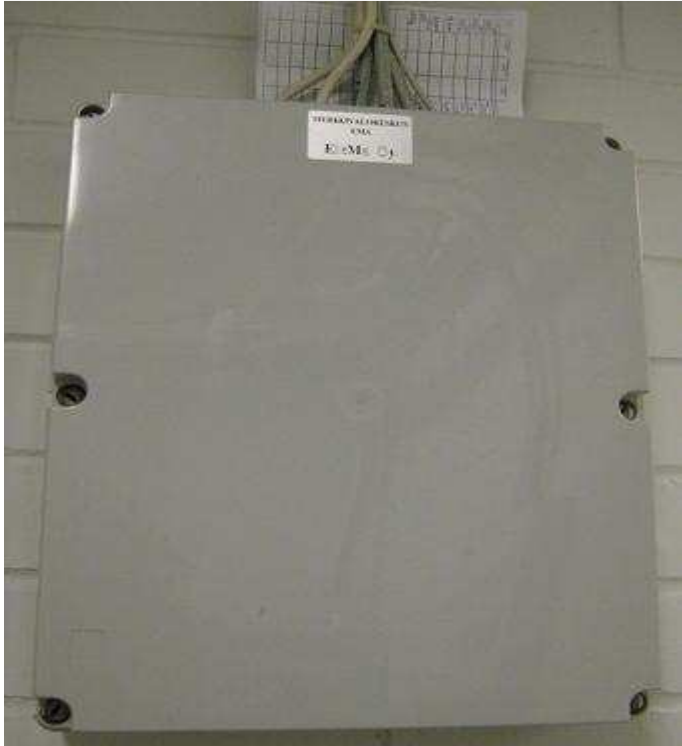
S-KUVA 17. Turva- ja merkkivalaistuskeskus pääkeskustilassa.
