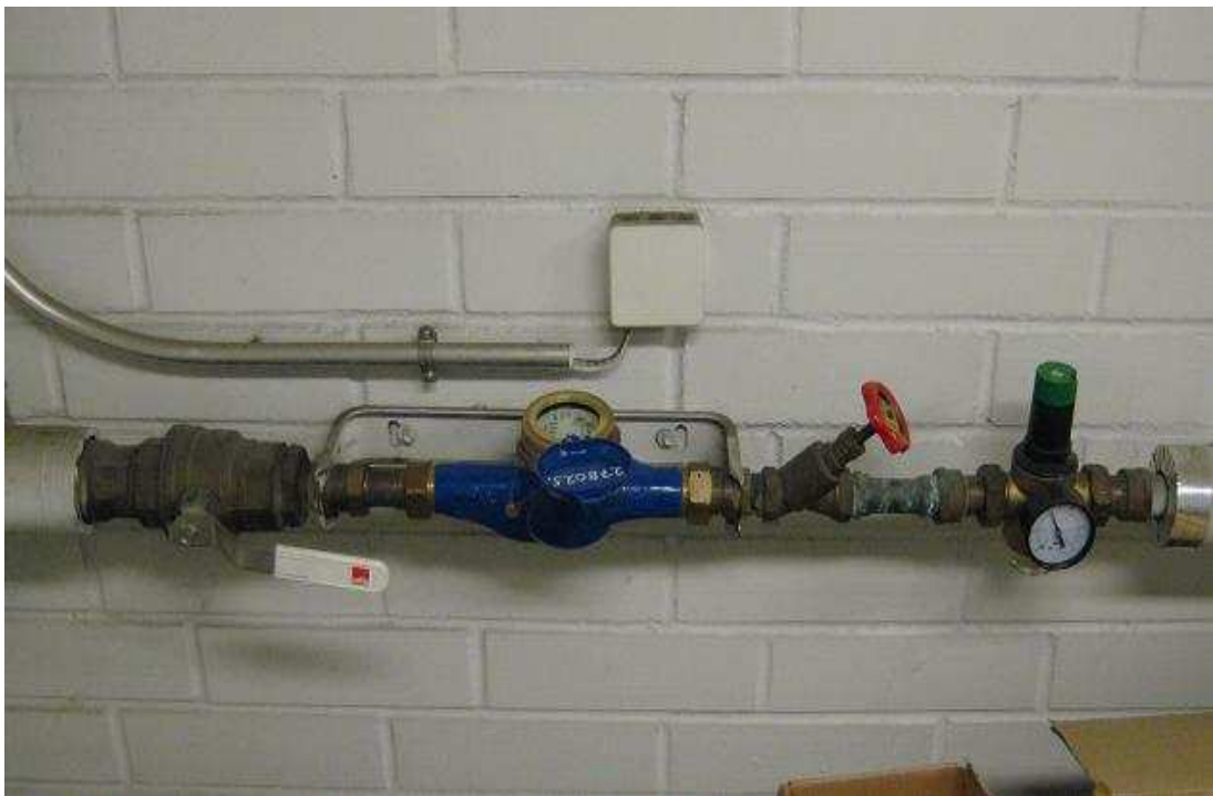
LVI-KUVA 6. Yleiskuva vesimittarista ja pääsulkuventtiileistä.
