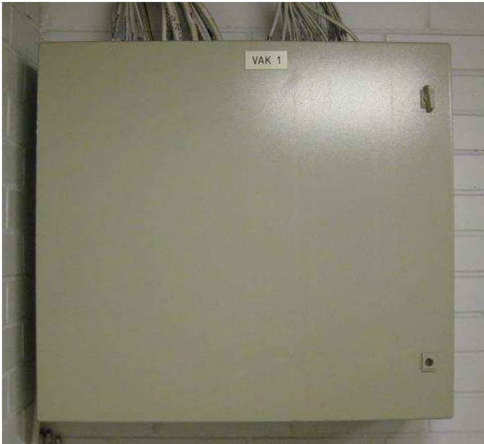
S-KUVA 20. Rakennusautomaatiojärjestelmä alakeskus pääkeskustilassa.
