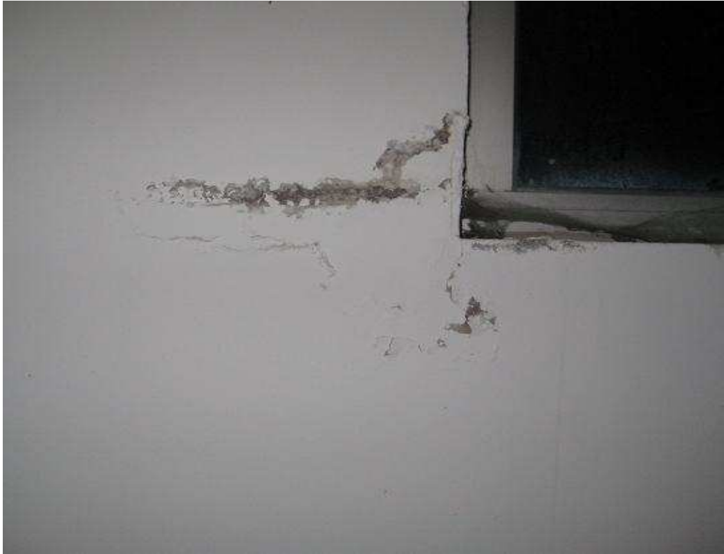
R-KUVA 9. Kylmän porrashuoneen seinän pintarakenteen vaurio.
