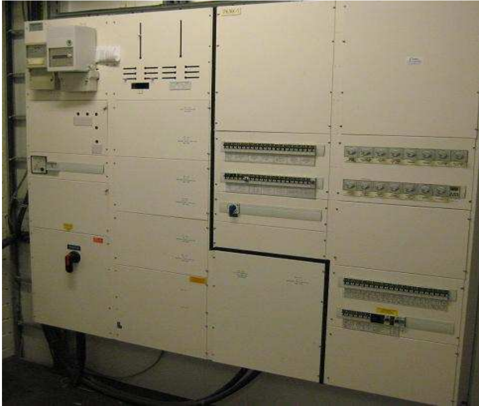
S-KUVA 1. Sähköpää- ja kiinteistökeskus.
