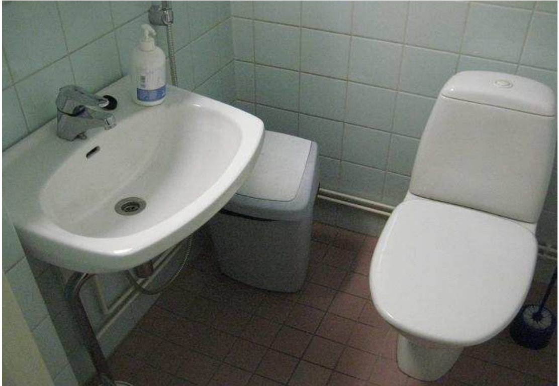
LVI-KUVA 7. Yleiskuva vesi- ja viemärikalusteista.
