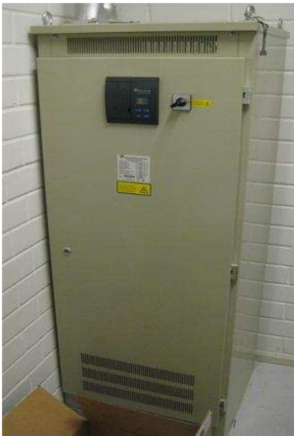
S-KUVA 6. Loistehonkompensointiparisto pääkeskustilassa.
