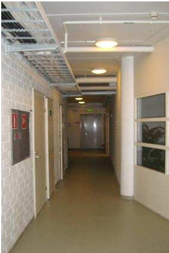
S-KUVA 10. Pohjakerroksen valaistus.
