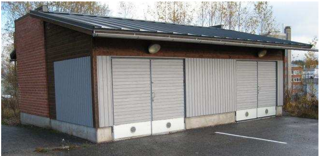
R-KUVA 2. Varastorakennuksen puutteelliset vesikourut.
