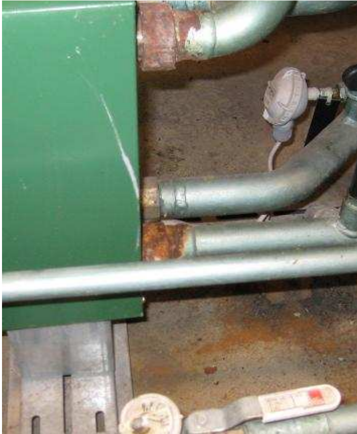
LVI-KUVA 3. Liitoskohtien ruostevauriot.
