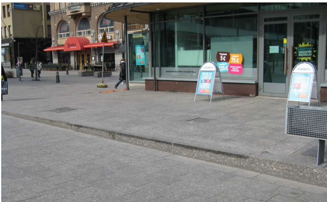
Kuva 27. Kävelykeskustassa Hovioikeudenpuistikolla on tasoeroja, joissa ei ole varoitusaluetta tai kontrastivärejä (Salla-Maija Vainio).
