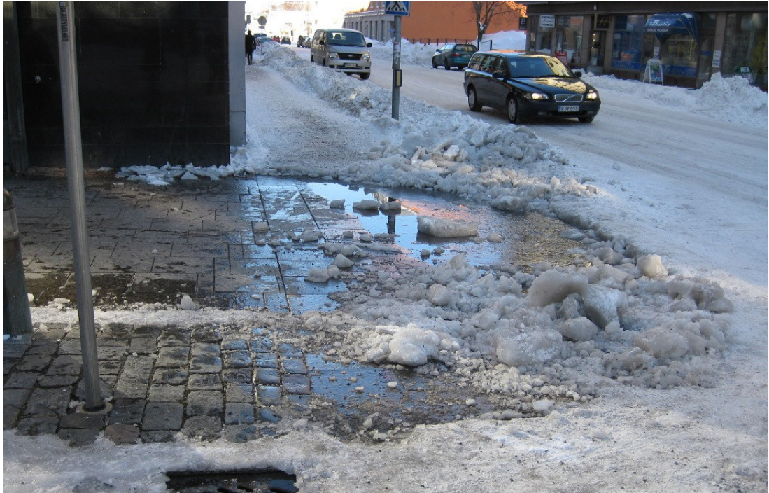
Kuva 56. Hovioikeudenpuistikon ja Pitkädun risteyksessä sulanapitoalueen reunassa sulanut vesi ei ole haihtunut (Salla-Maija Vainio).
