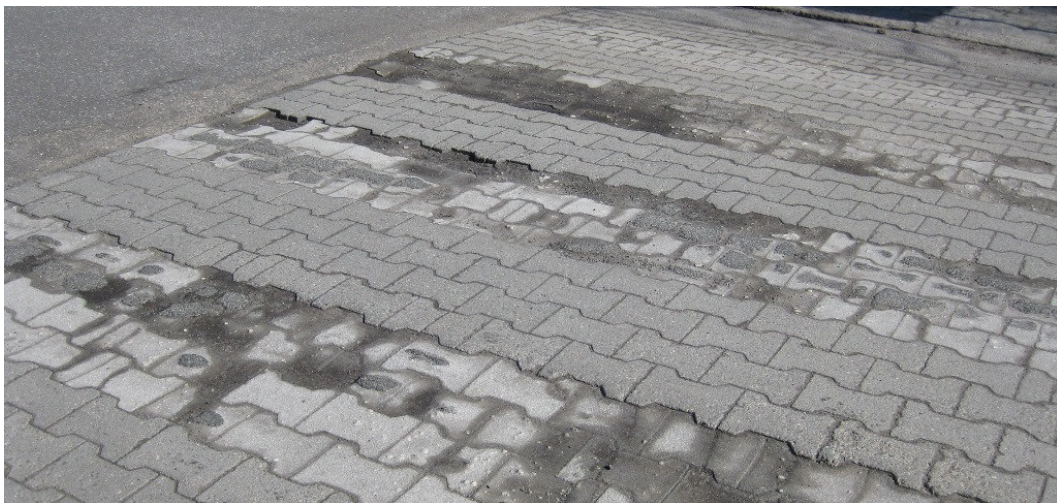
Kuva 18. Kaksi eriväristä betonikiveä on kulunut epätasaisesti suojatien kohdalla. Kuvauspaikka ei ole kartoitusalueella. (Salla-Maija Vainio.)
