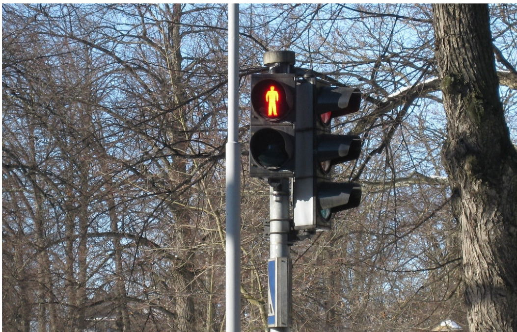
Kuva 45. Vaasanpuistikon ja Raastuvankadun risteykseen on asennettu led-lamput jalankulkua ohjaaviin liikennevaloihin (Salla-Maija Vainio).
